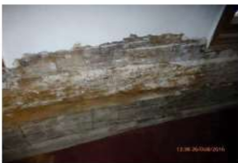
Ad c) poškození dřevěných prvků
