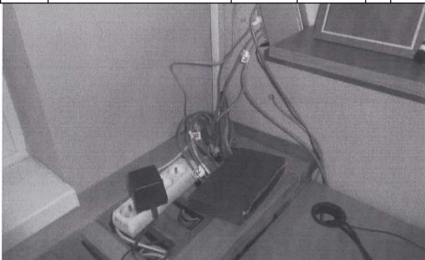
Switche v m.č. C113- pav. C - 2.NP switche, včetně veškeré kabeláže, budou demontovány.
