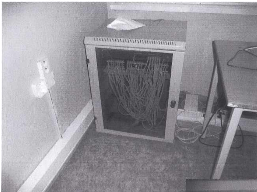
Rozvaděč v PC učebně m.č. E207, 3.NP – pav. E (R-6)
