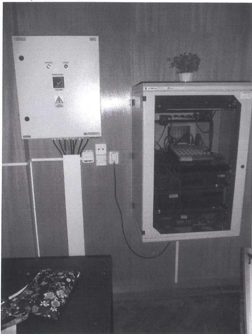
Rozvaděč v aule – pav. TV – 1.NP (R-11)
