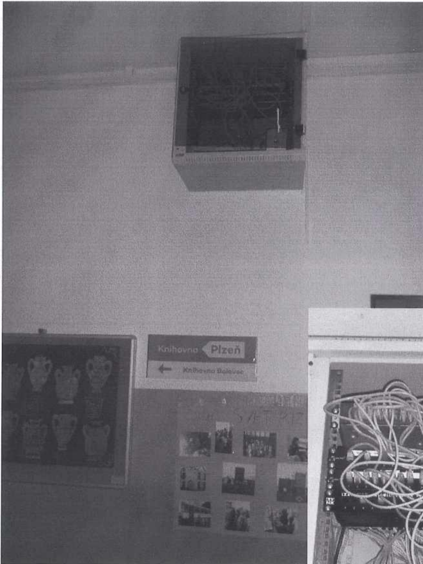
Rozvaděč na chodbě, v pav. C – 2.NP (R-8)
