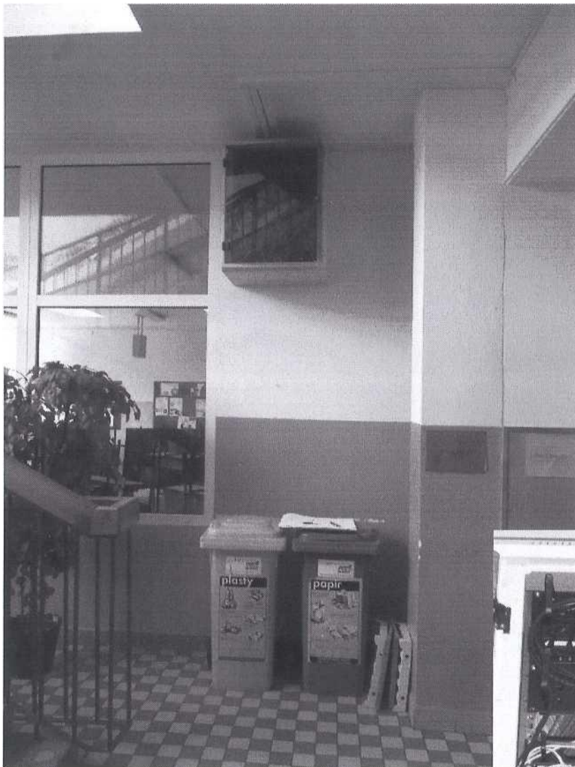
Rozvaděč na chodbě mezi pavilony TV a C, 1.NP (R-3)
