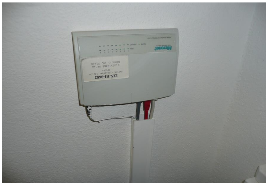
Switch v m.č. B004 – pav. B - 1.NP
