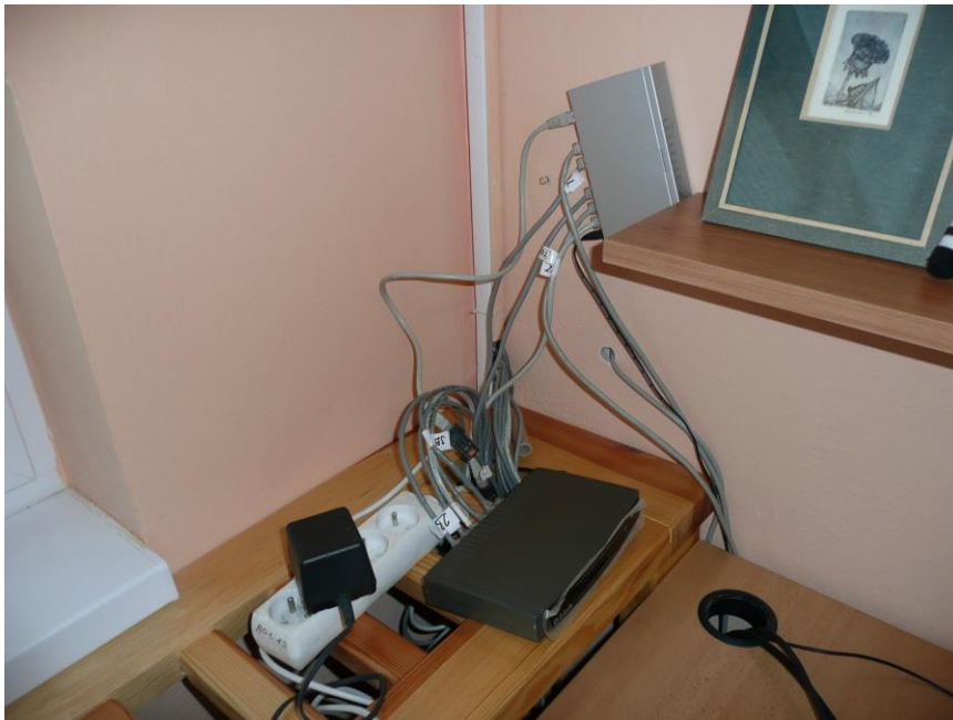
Switche v m.č. C113 – pav. C - 2.NP
