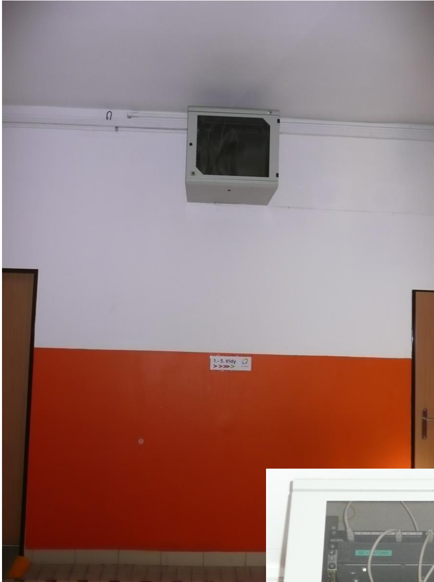
Rozvaděč na chodbě, v pav. TV – 2.NP (R-9)
