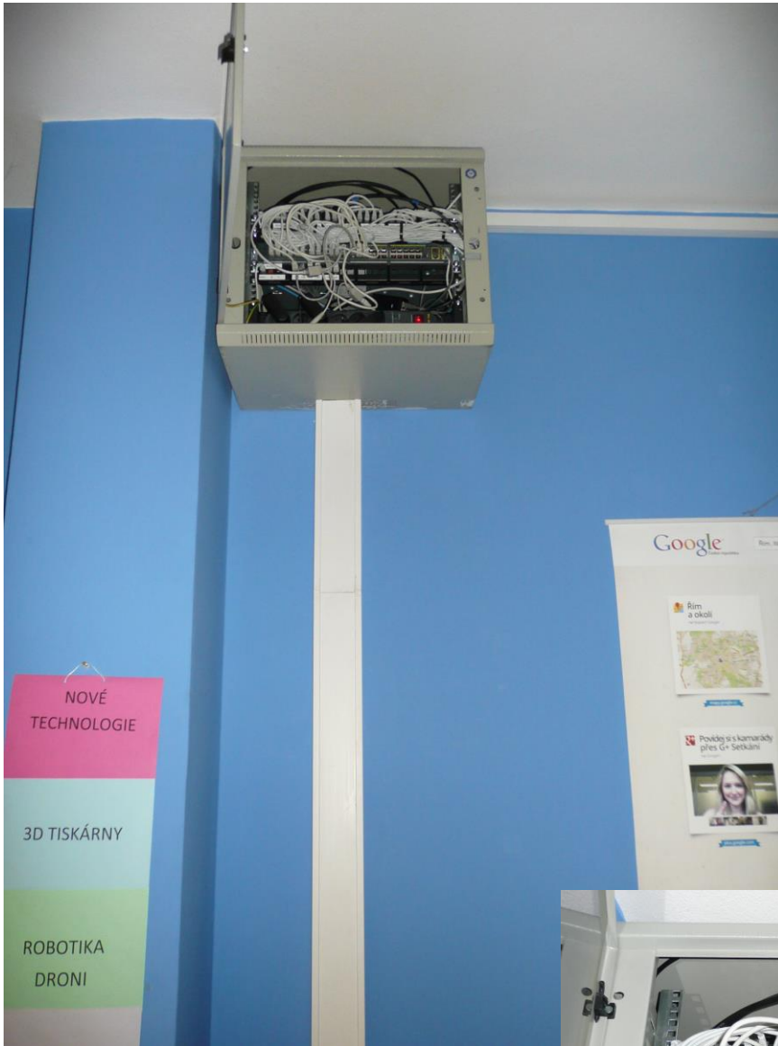
Rozvaděč v PC učebně č. B208, 3.NP – pav. B (R-4)
