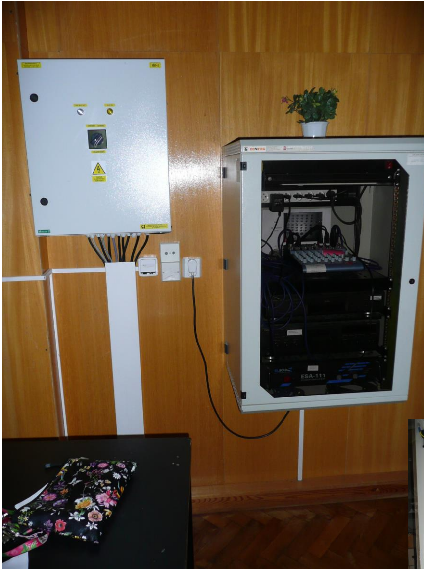
Rozvaděč v aule – pav. TV – 1.NP (R-11)
