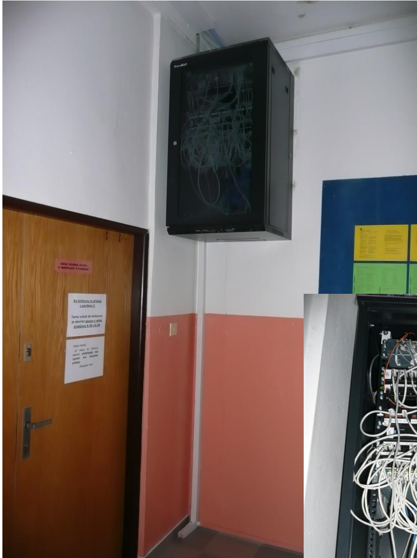
Rozvaděč na chodbě, v pav. B – 2.NP u m.č. B102 (R-5)
