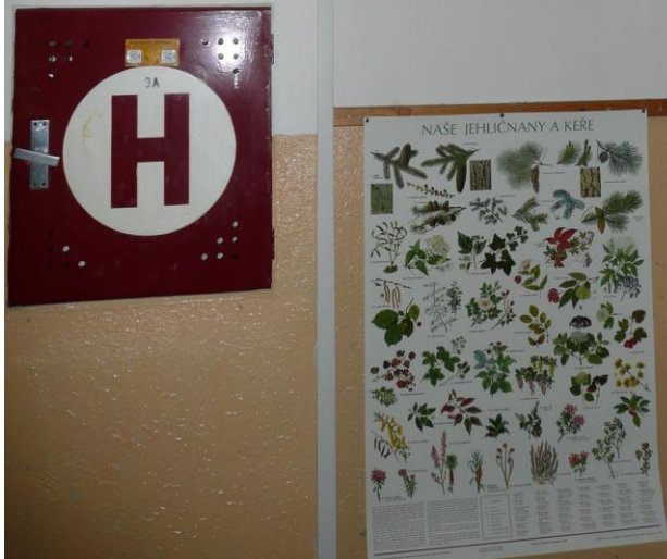
Rozvaděč na chodbě, v pav. D – 2.NP (R-10)
