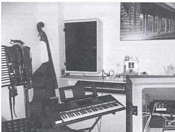
Rozvaděč v ZUŠ m.č. 2.44 - 2.NP (R-7)
