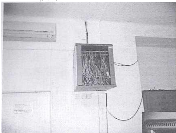
Rozvaděč v PC učebně m.č. 122 – 4.NP (R-5)
