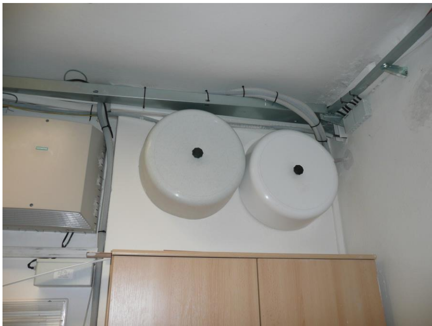
Zakončení stávajících optických kabelů v technologické místnosti – 1.PP
