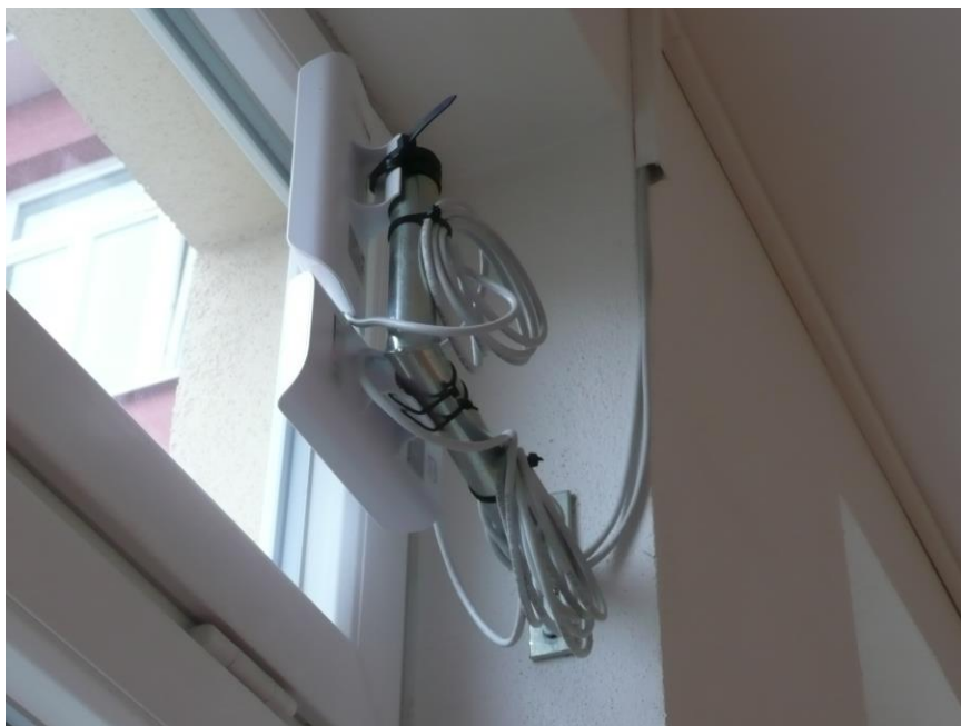
Pojítka O2 na chodbě m.č. 2.45 – 2.NP
