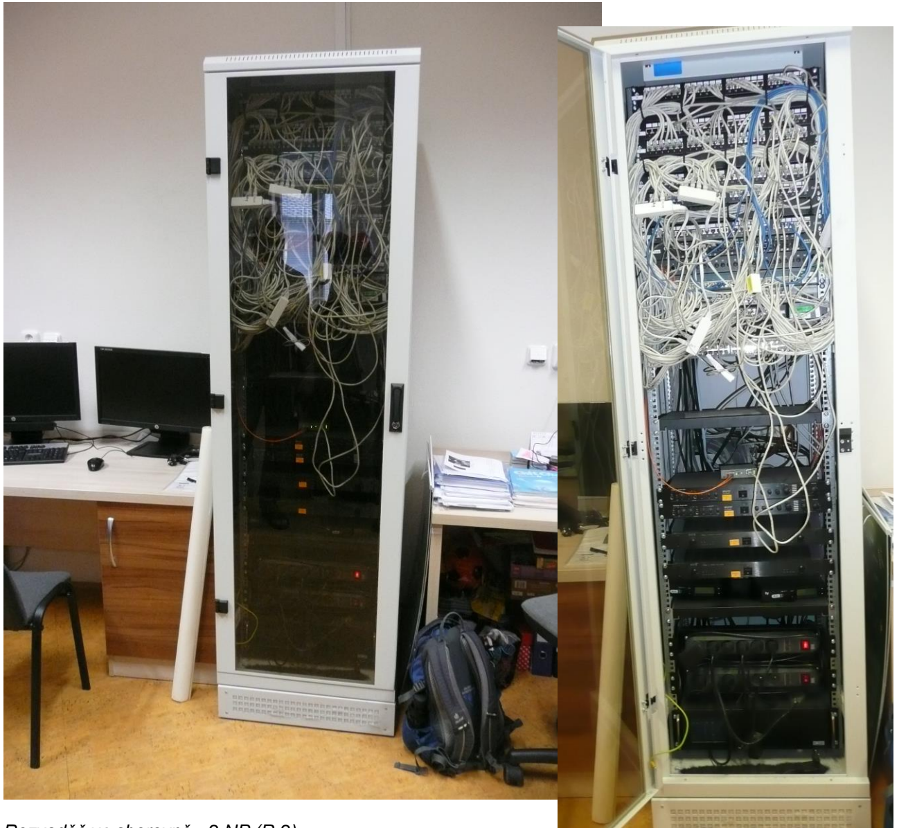
Rozvaděč ve sborovně - 2.NP (R-2)
