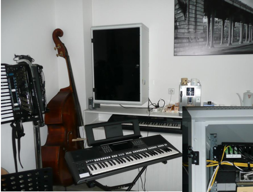
Rozvaděč v ZUŠ m.č. 2.44 – 2.NP (R-7)
