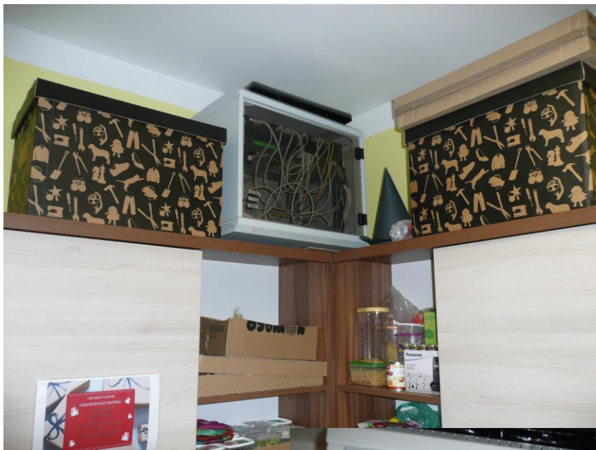
Rozvaděč ve školním klubu m.č. 0.34 – 1.PP (R-10)
