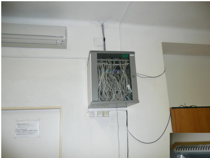
Rozvaděč v PC učebně m.č. 122 – 4.NP (R-5)
