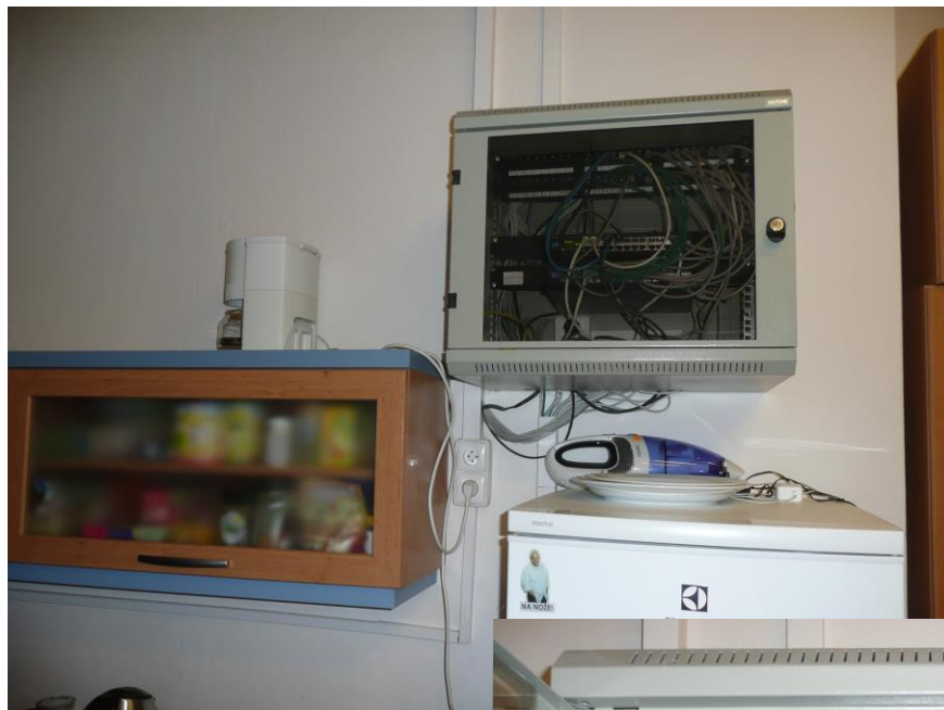
Rozvaděč ve sborovně m.č. 45 – 3.NP (R-12)
