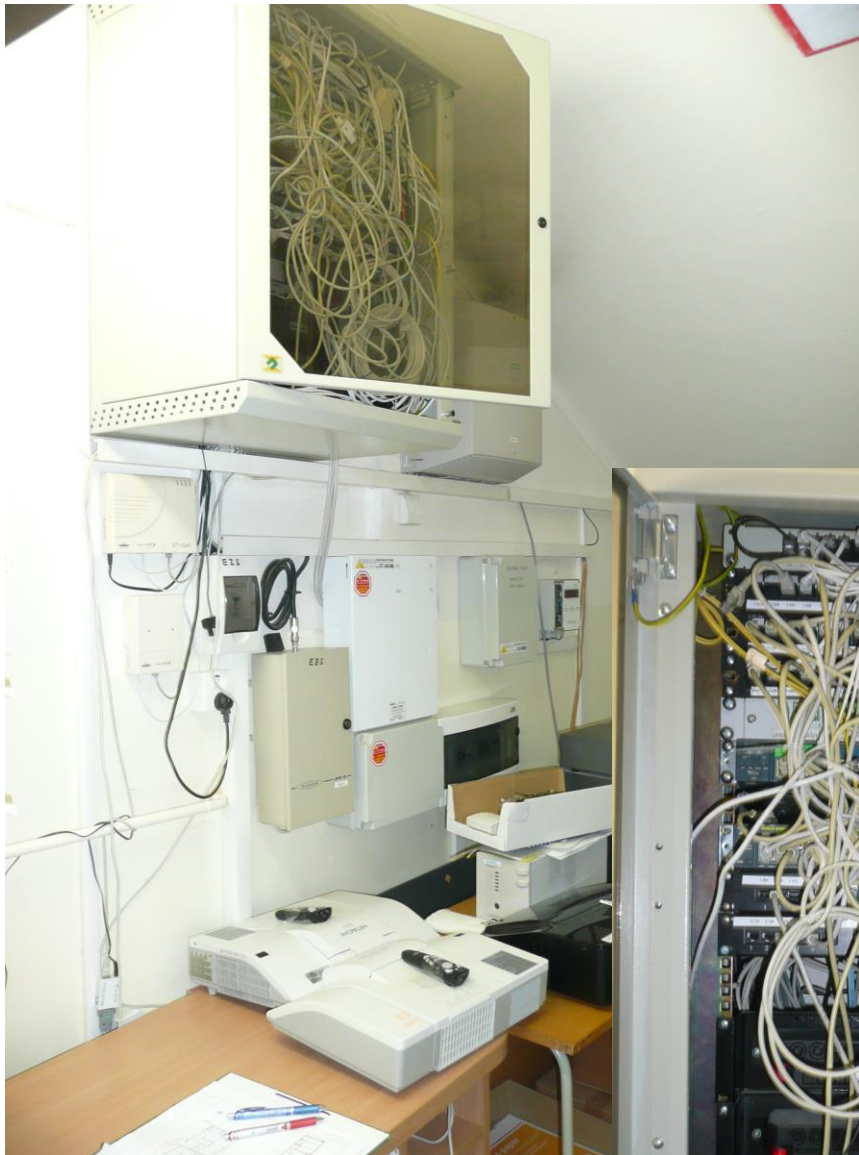
Rozvaděč v technologické místnosti pod schody (vedle sekretariátu) - 1.NP (ZŠ)
