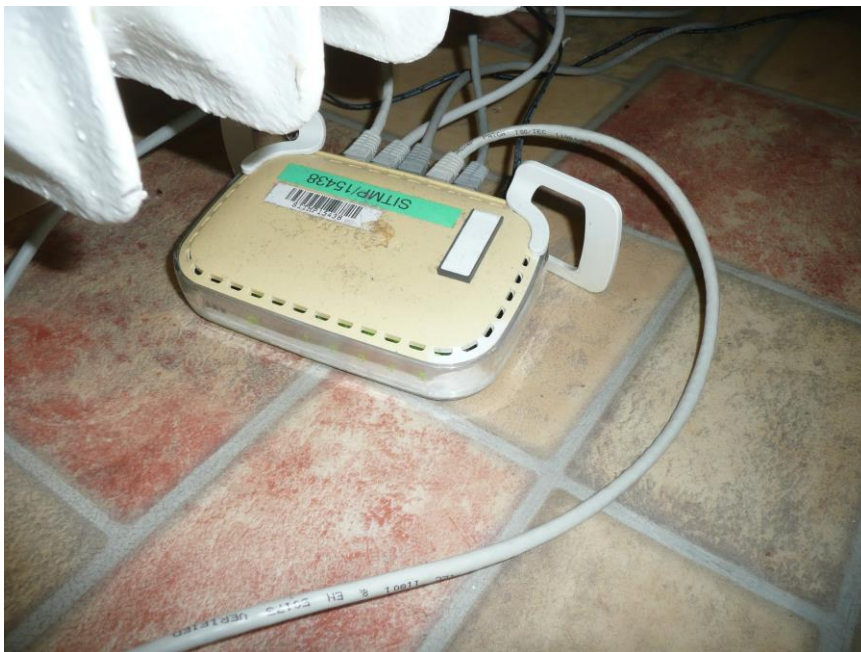
Switch v kabinetu č. 28 – 2.NP (ZŠ)
