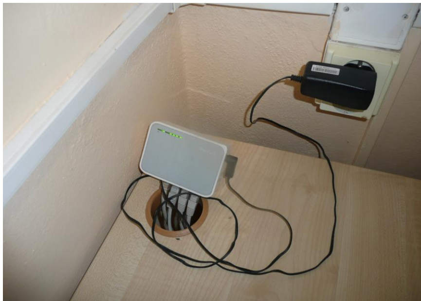
Switch v kabinetu č. 100 – 1.NP (ZŠ)
