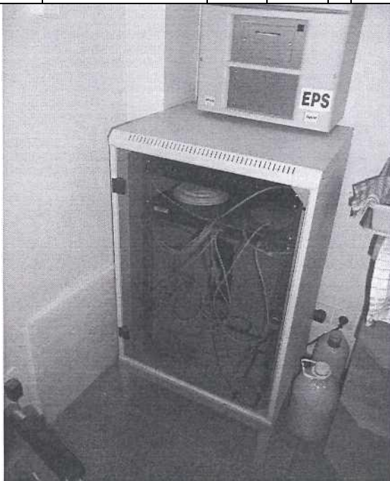
Rozvaděč v nové hale - místnost č. 1.04 - 1.NP
