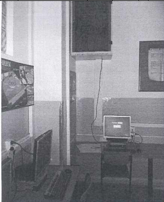
Rozvaděč v místnosti počítačové učebny č. 87 - 4.NP
