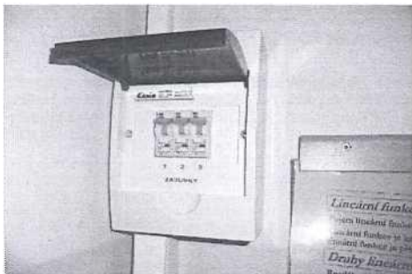
Stávající rozvaděč NN rozvodů v učebně PC(MA) - 4.NP
