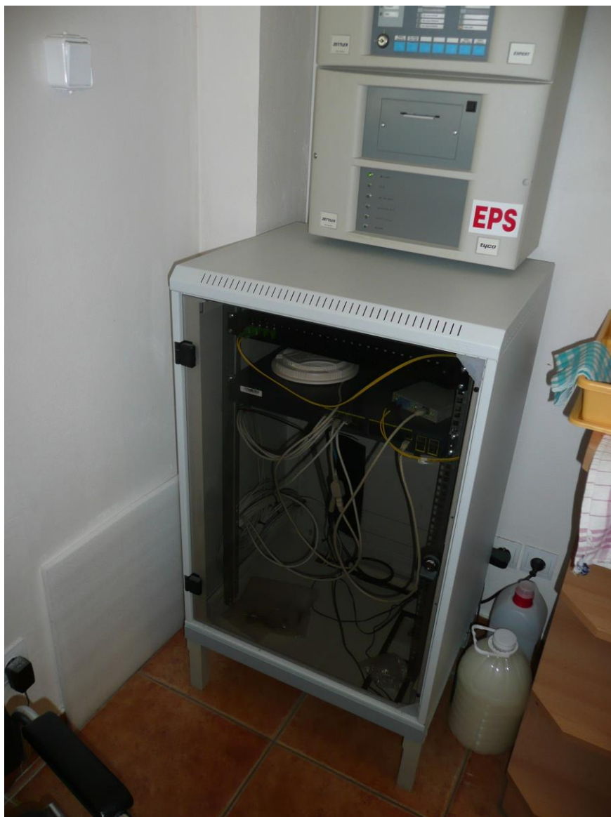
Rozvaděč v nové hale - místnost č. 1.04 - 1.NP
