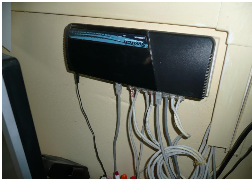
Switch v místnosti kabinetu TV - 1.NP pavilón 6.-9.
