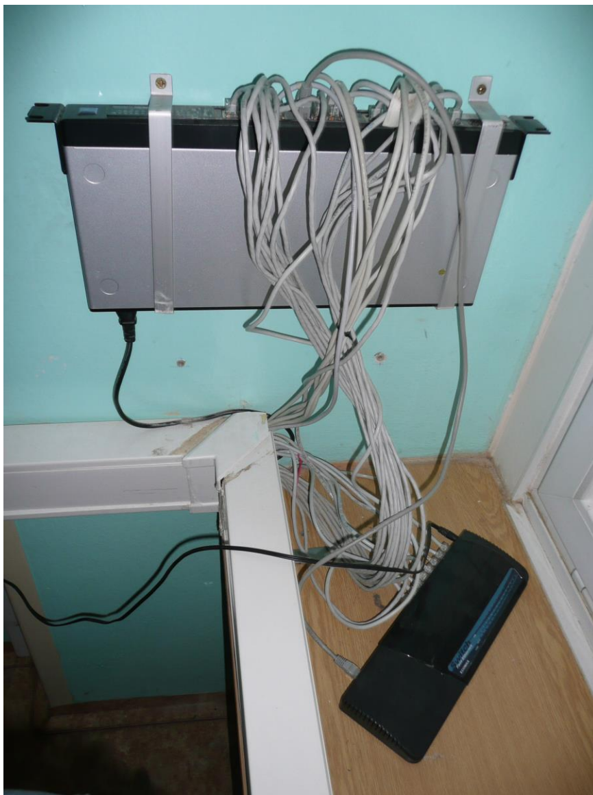
Switche v místnosti učebny PC(MA) - 4.NP pavilón 6.-9. (m.č. 80).
