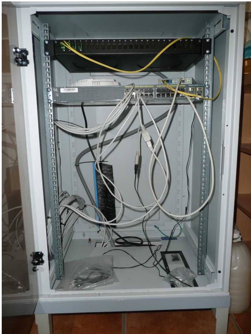
Rozvaděč v nové hale - místnost č. 1.04 - 1.NP
