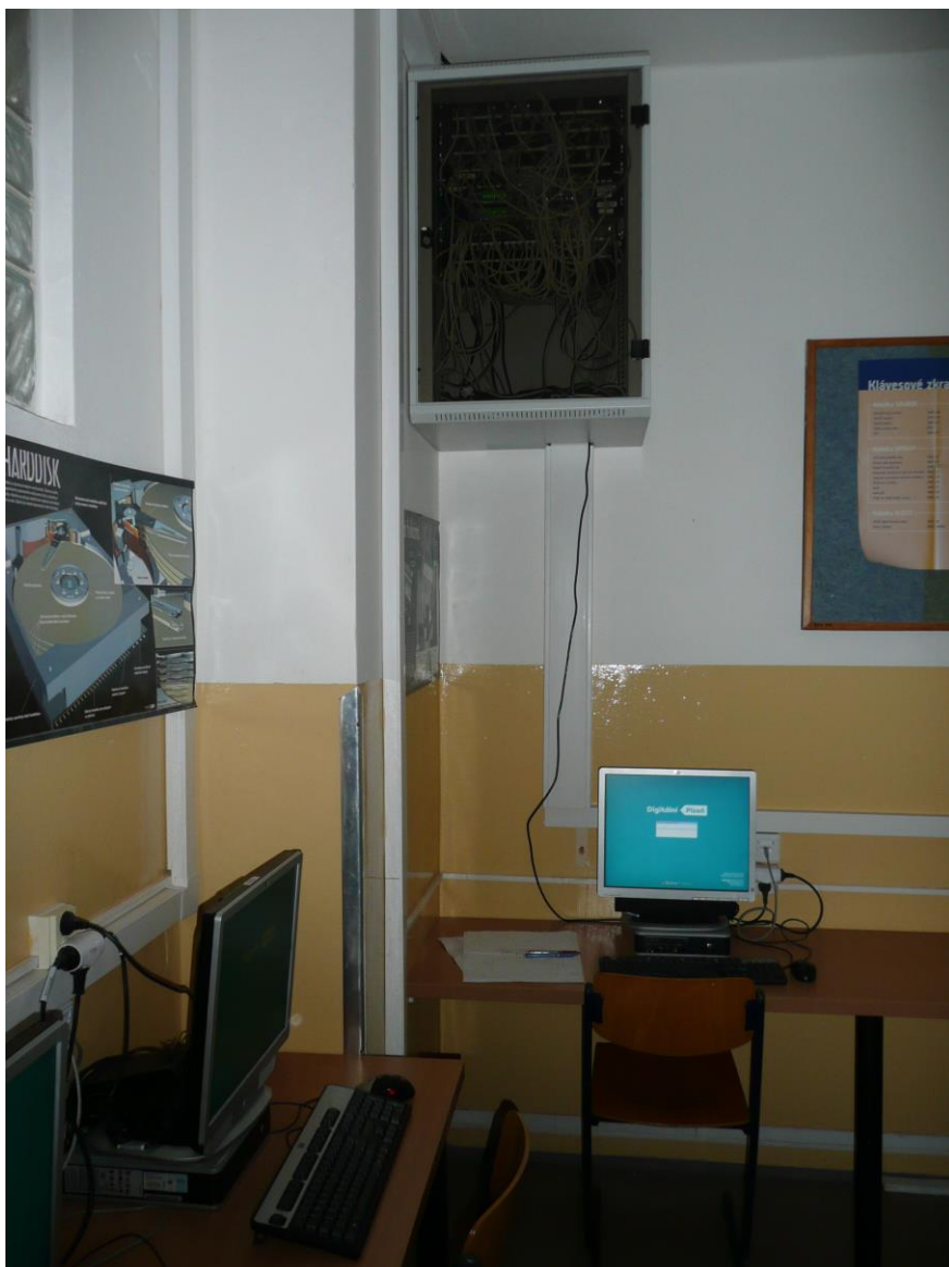
Rozvaděč v místnosti počítačové učebny č. 87 - 4.NP
