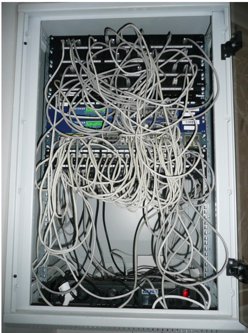
Rozvaděč v místnosti počítačové učebny č. 87 - 4.NP
