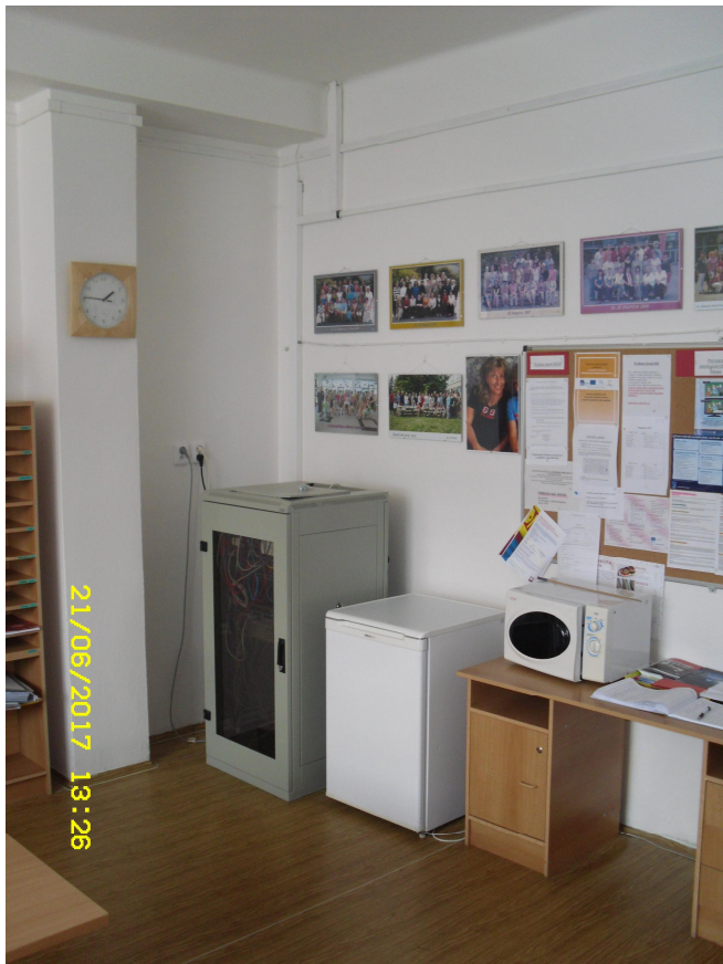
c) 1.NP, pavilon tříd pravý (objekt U8), umístění na podlaze v učebně č. 4 (sborovna)
