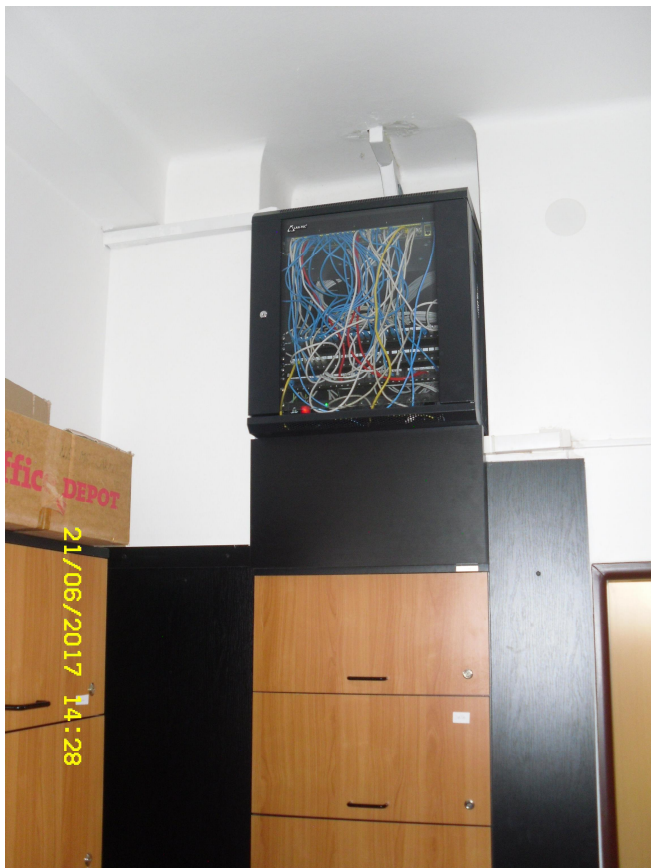
d) 1.NP, pavilon tříd levý (objekt U10), umístění na stěně pod stropem v místnosti č. 42
