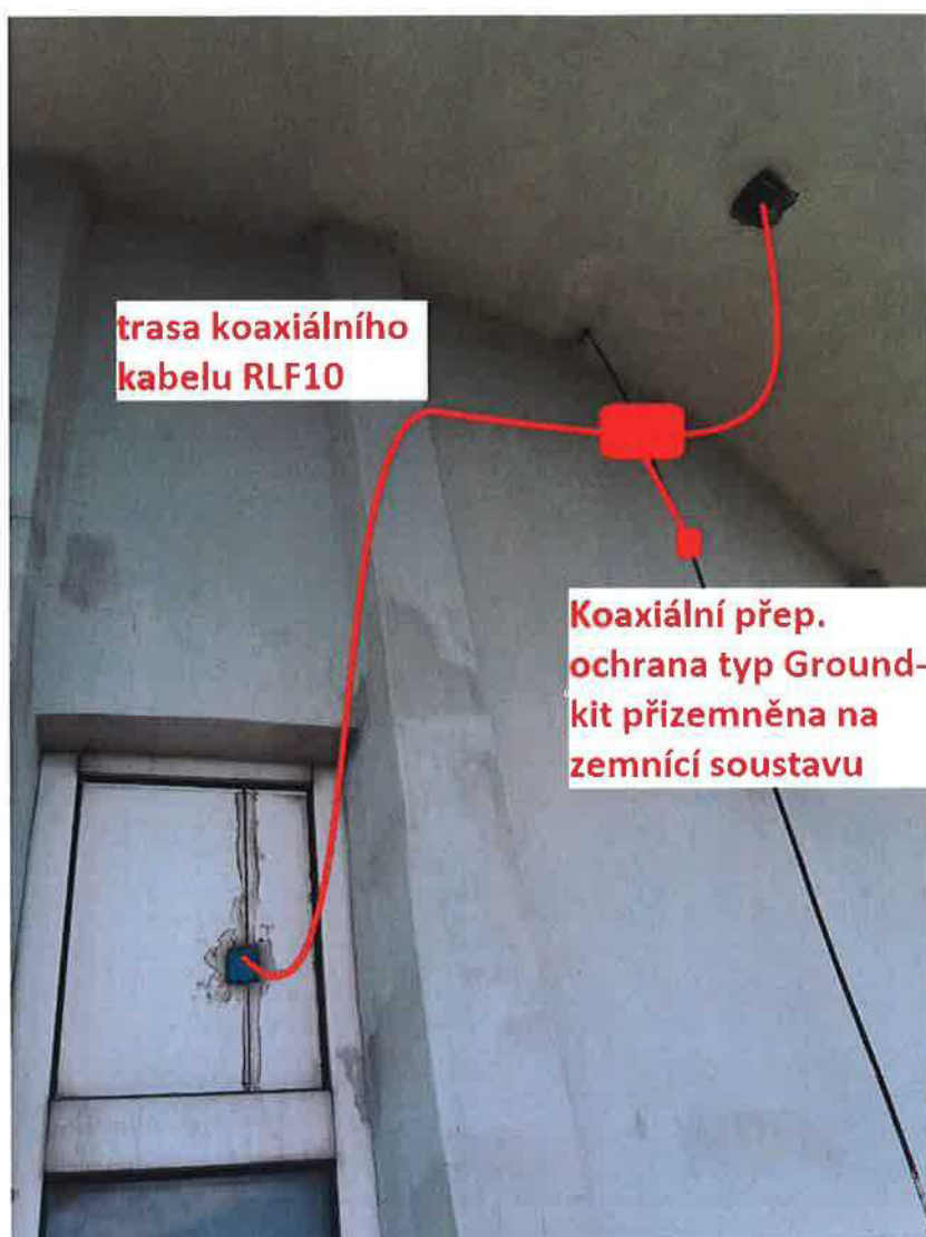
Obr.2: Trasa koaxiálního svodu vně objektu
