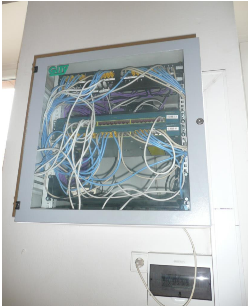
Rozvaděč v místnosti počítačové učebny č. 67 - 3.NP
