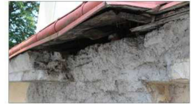
obr. 2 - poškozená část římsy
