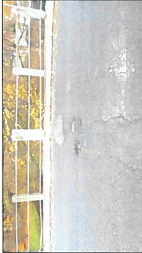
Poruchy ve vozovce
