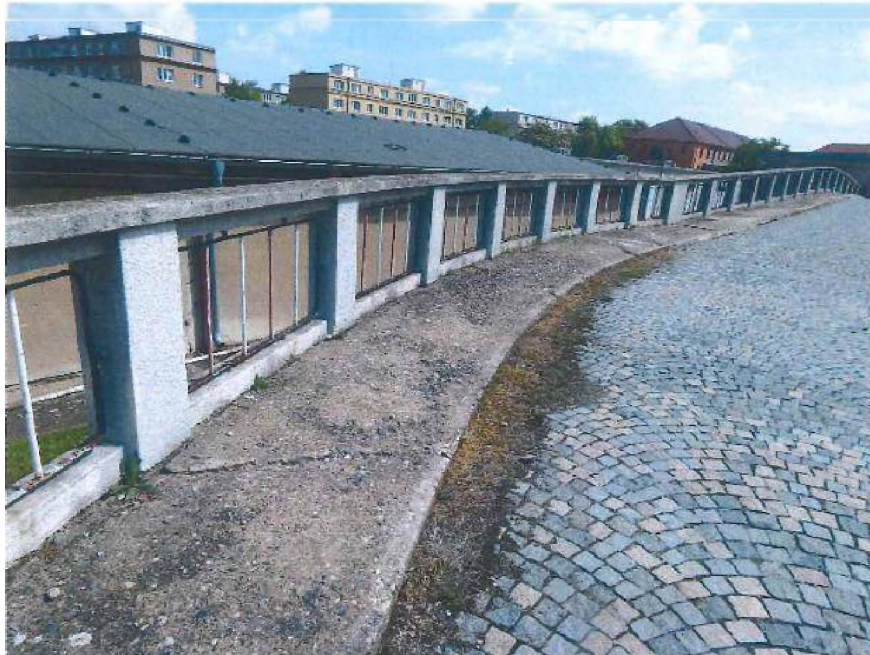
Rozpadlý povrch chodníku a vegetace v kraji komunikace
