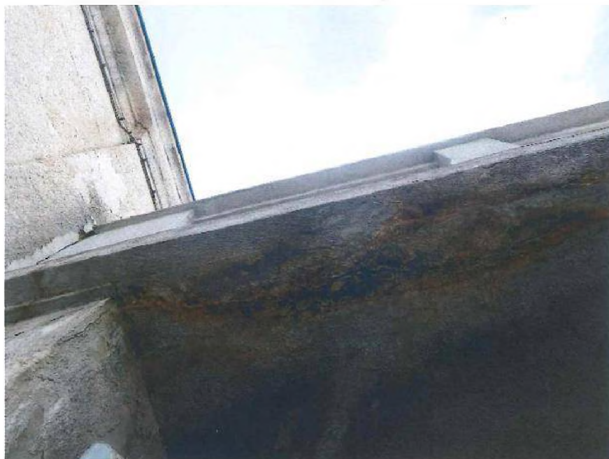
Zatékání vody v krajních částech nosné konstrukce
