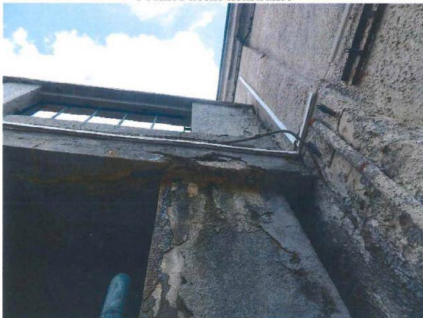
Zatékání do konstrukce mostu
