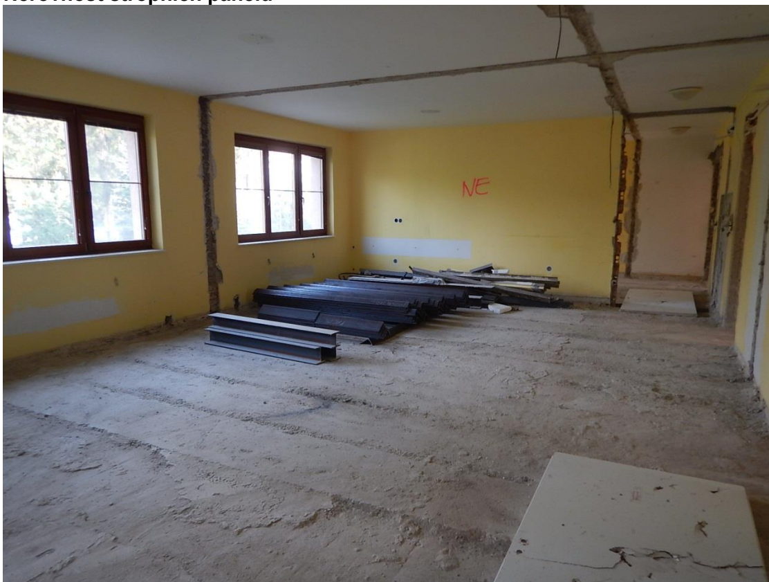
Nerovnost stropních panelů
