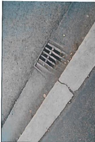
Čistěná znečištěná odvodňovací na mostě
