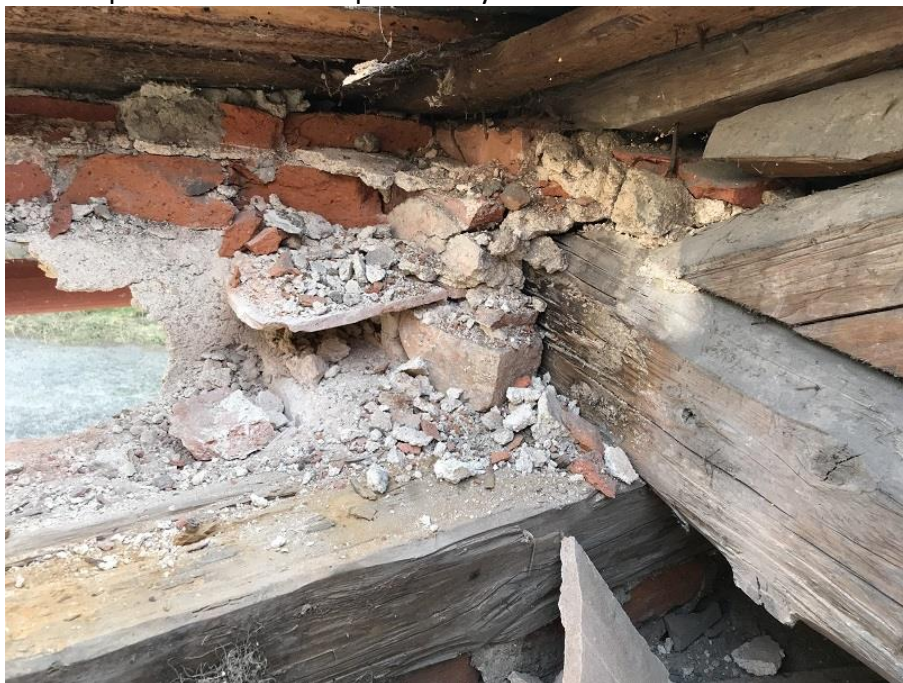
Sonda střecha západní křídlo + foto poškozených konstrukcí
