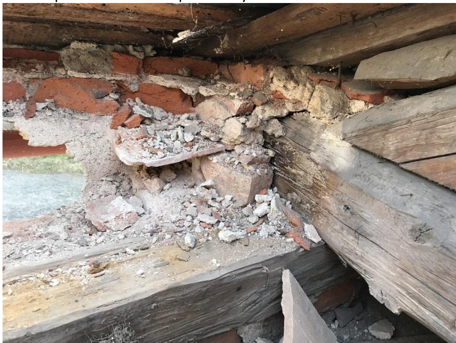
Sonda střecha západní křídlo + foto poškozených konstrukcí
