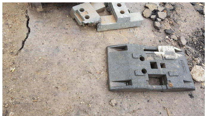
Trhlina v živici nad hranou svahu
