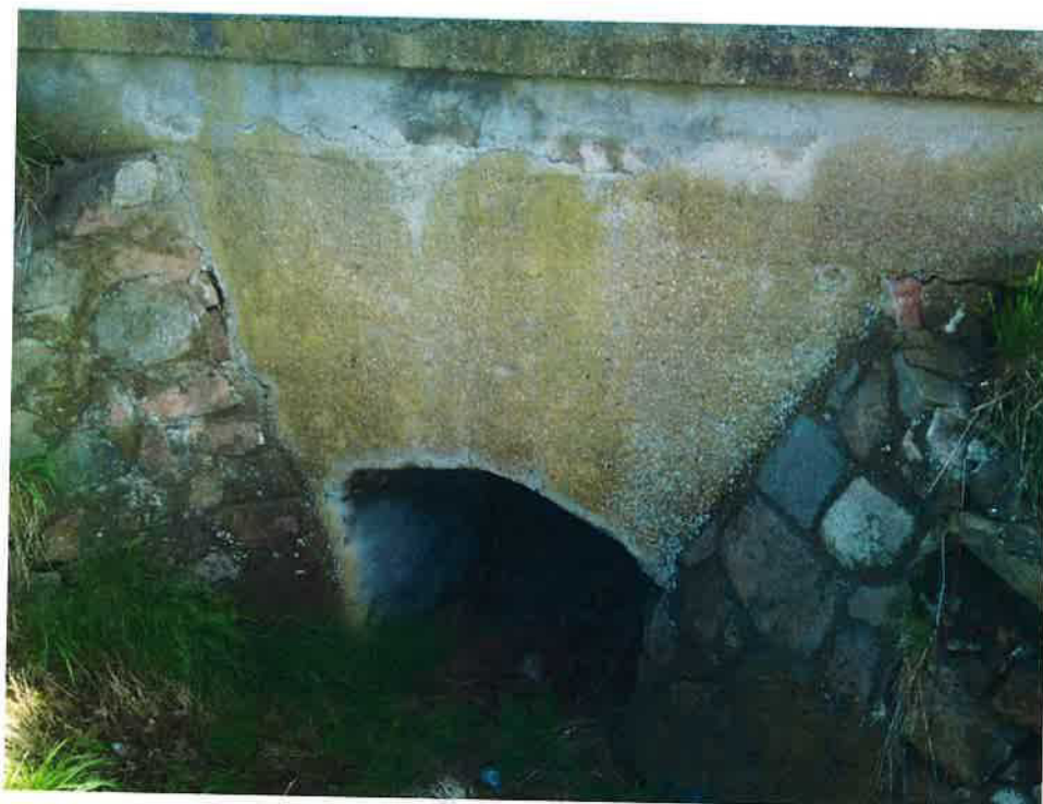
Stávající stav propustku na II/112 v km cca 3,80
