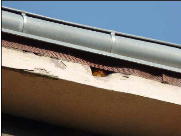
Detail poškození římsy – vletový otvor do hnízda
