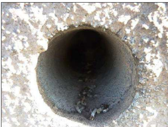
Trus drobných pěvců v ústí ventilačního otvoru
