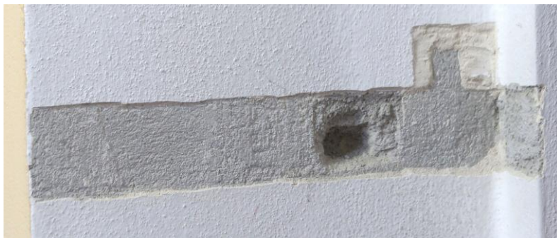
sonda P/2 -jižní stěna vítězného oblouku - novodobá cementová omítka s jemným štukem
