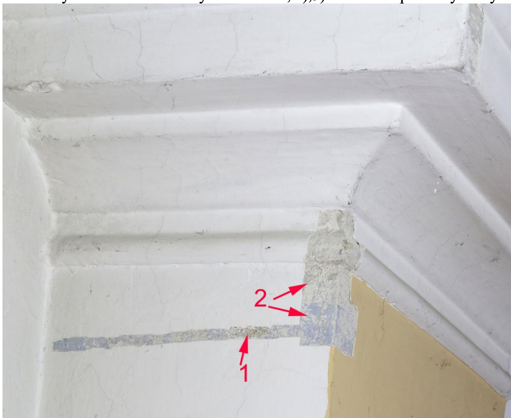
sonda K/6- pilastr jižní stěny kůru, 1),2)- hrubší tmavě šedá vápenná omítková vrstva s výmalbou v šedě modrých odstínech,
