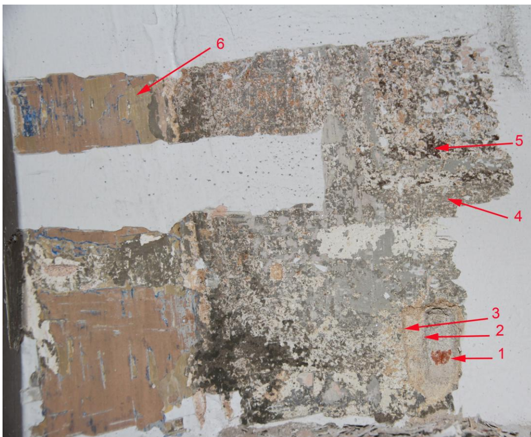
sondy P/13- severní stěna presbytáře- 1)- cihlové zdivo 2) -jádrová vápenná omítka, 3)-jemná vápenná do růžova barvená originální omítka s vápenným pačkem 4)-hrubší tmavě šedá vápenná omítková vrstva s výmalbou v šedém odstínu, 5) - mladší ornamentální výmalba, 6)- mladší hlinkové výmalby
