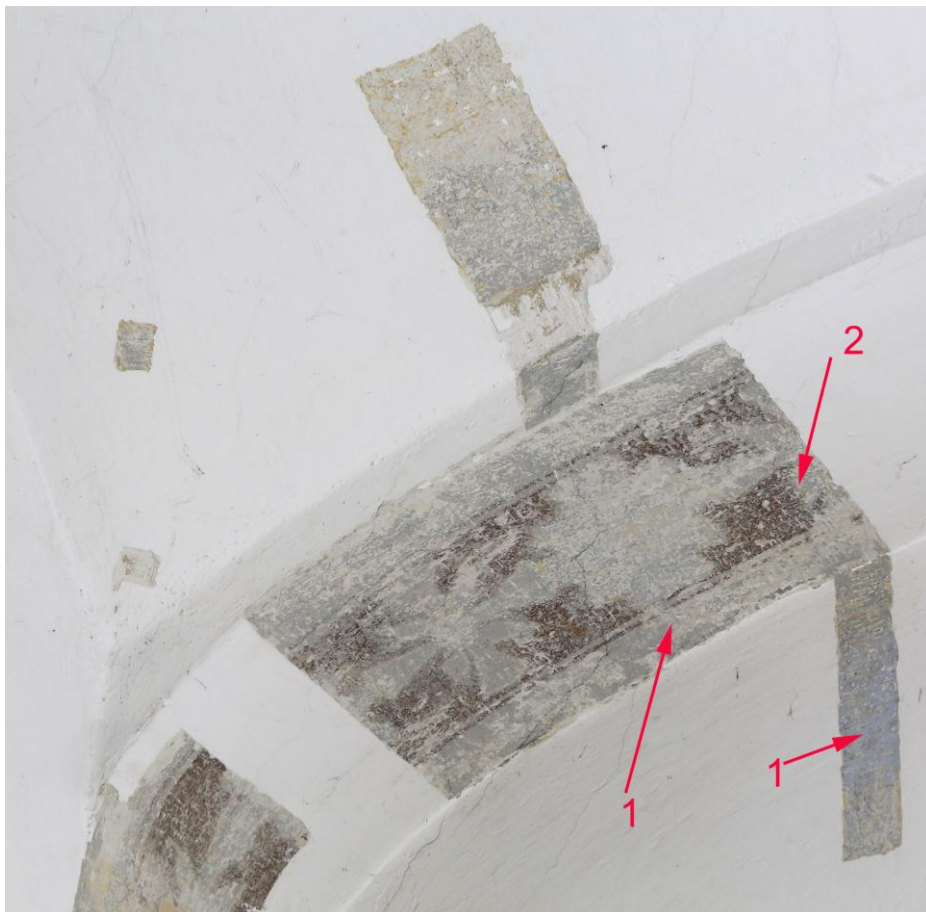
sondy K/1, K/2 a K/7- východní a jižní stěna kůru,1)- hrubší tmavě šedá vápenná omítková vrstva s výmalbou v šedě modrých odstínech,2) - mladší hlínkové výmalby
