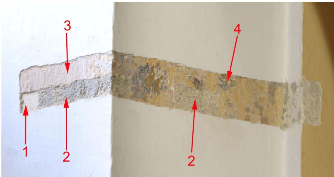
sonda P/6 -jižní stěna presbytáře - 1)- jemná vápenná do růžova barvená originální omítka s vápenným pačkem ,2)-hrubší tmavě šedá vápenná omítková vrstva s výmalbou v šedém odstínu, 3) - mladší růžová výmalba na vápenném pačoku, 4)- mladší hlínkové výmalby
