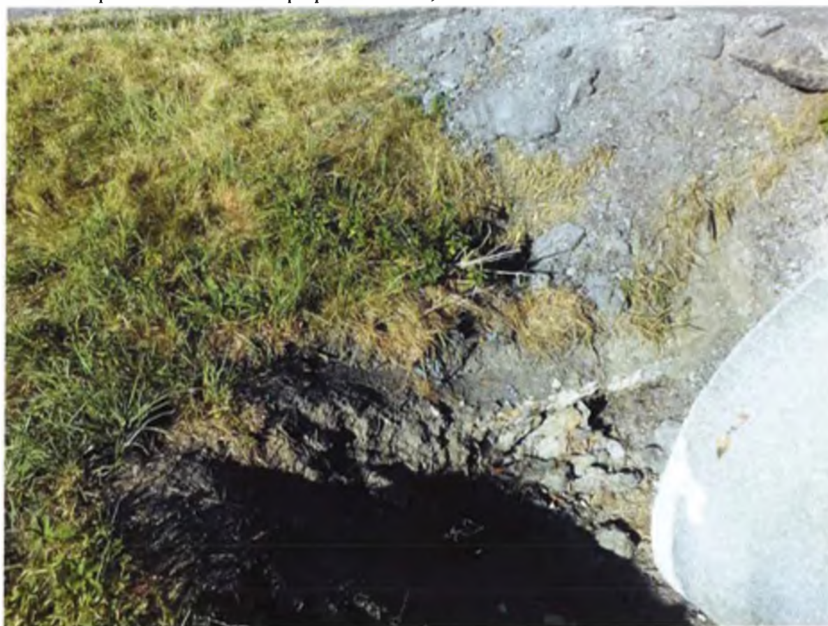
Obnažené pravé čelo kamenného propustku v km 8,030 SO 103
