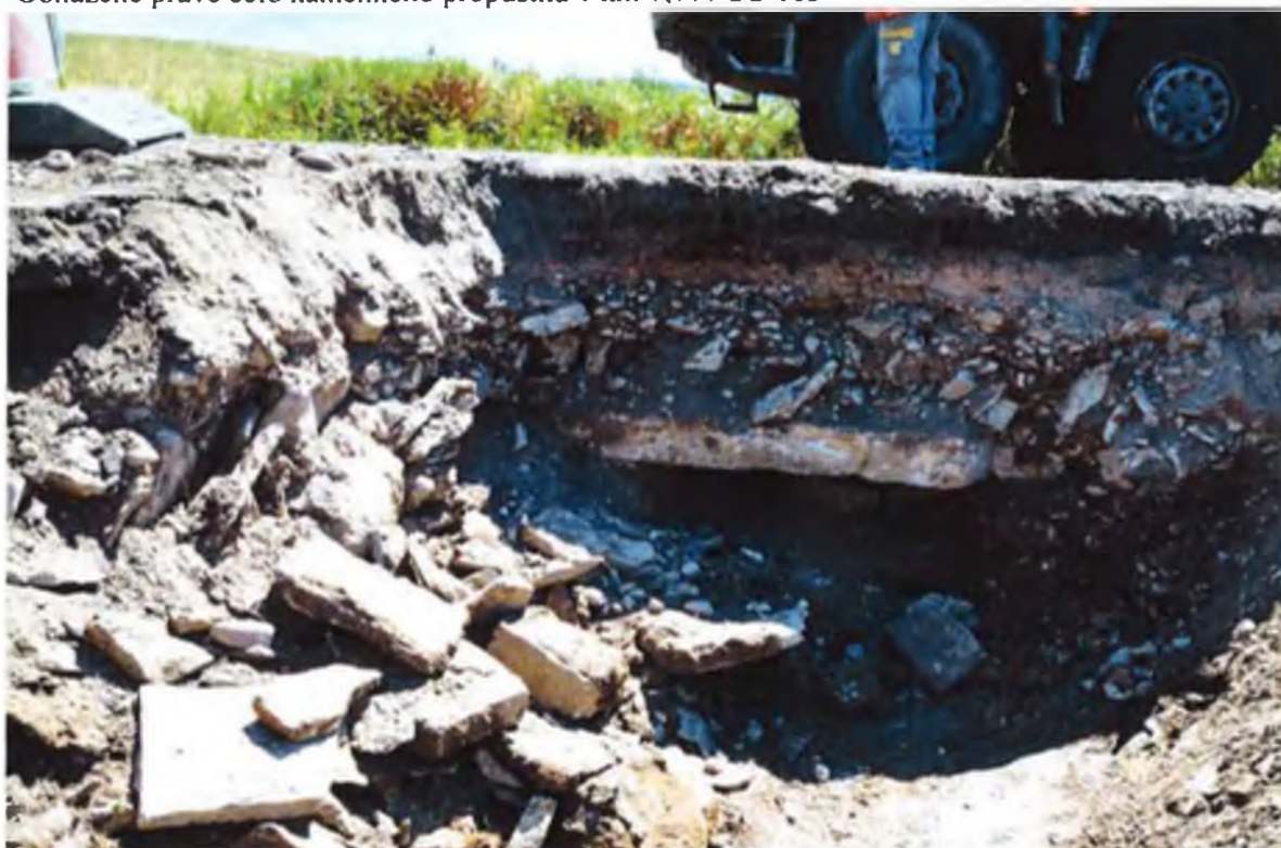
Obnažené pravé čelo kamenného propustku v km 7,777 SO 103
