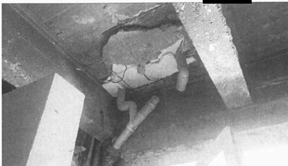
Obrázek 2: Pohled na typické poškozené místo
