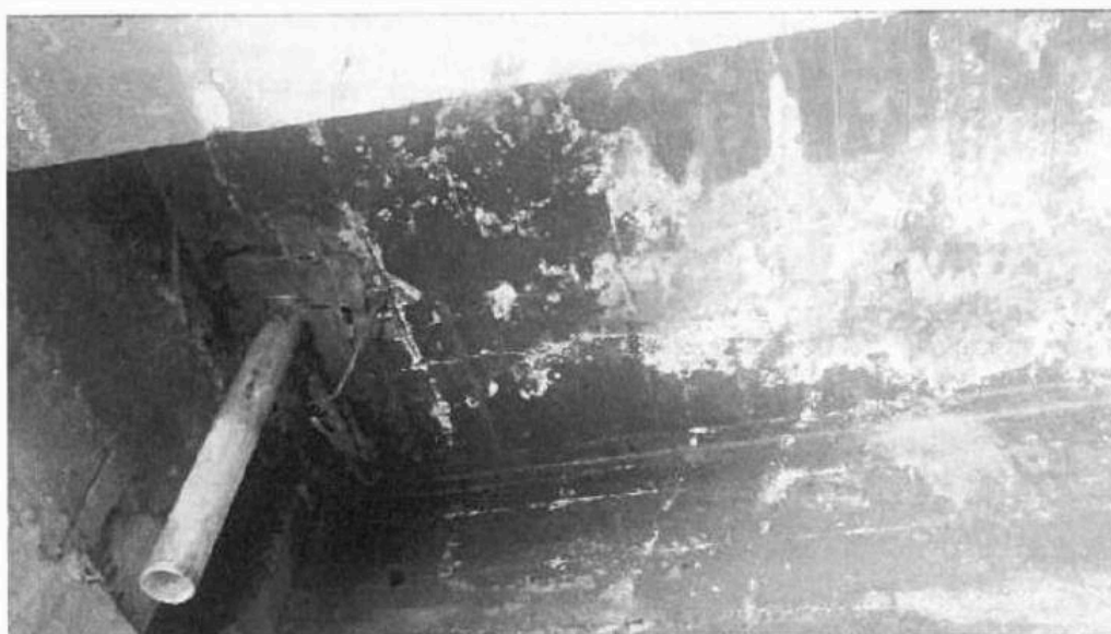
Obrázek 3: Místo s vlhkostní degradací
