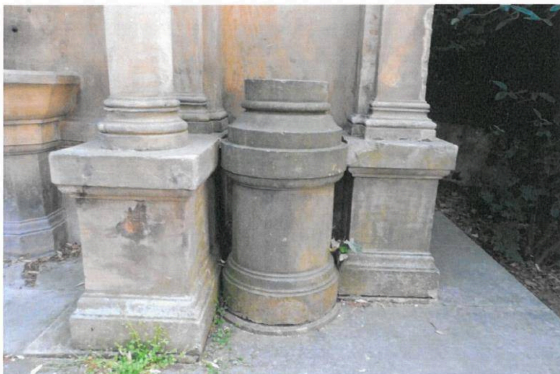
Ve spodních částech podstavců je dožitě spárování, místy chybí.
