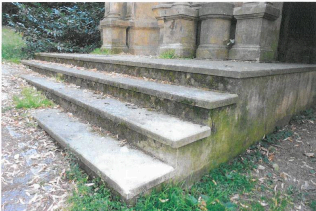
Povrch kamene je poškozený biologickým napadením.
