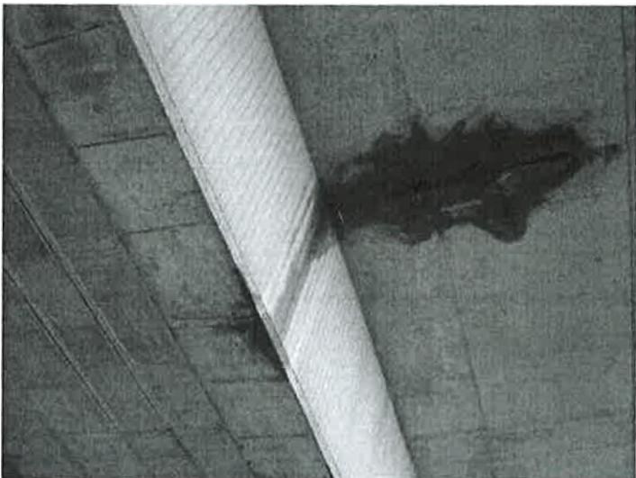
průsak z odvodňovacího otvoru na spodní líc pravé konzoly
