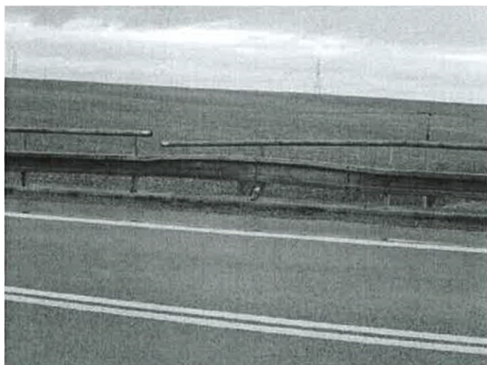
typický stav zábradelního svodidla v místě nárazu
