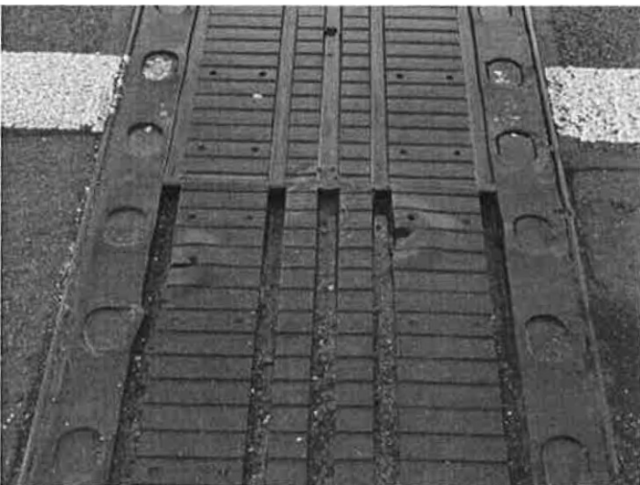
DTTO - poruchy MZ před roztržením
