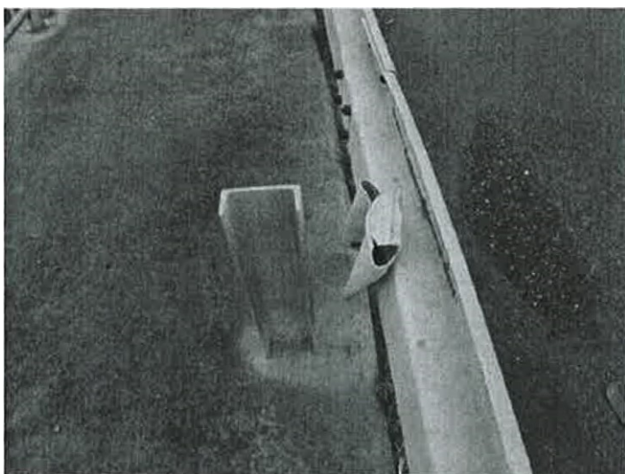
typický stav svodidla v místě nárazu
