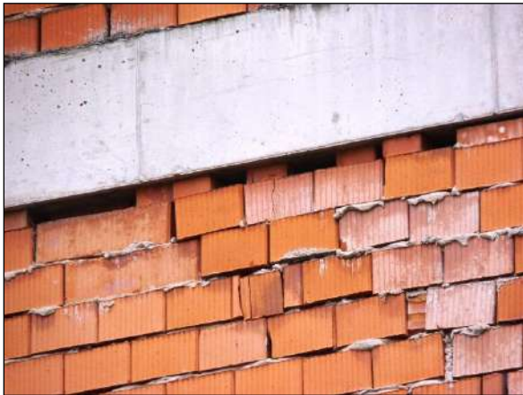
Poškození neomítnutého zdiva – obvyklý, úkryt ptáků i netopýrů
