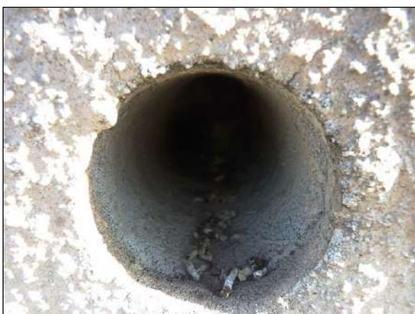
Trus drobných pěvců v ústí ventilačního otvoru
