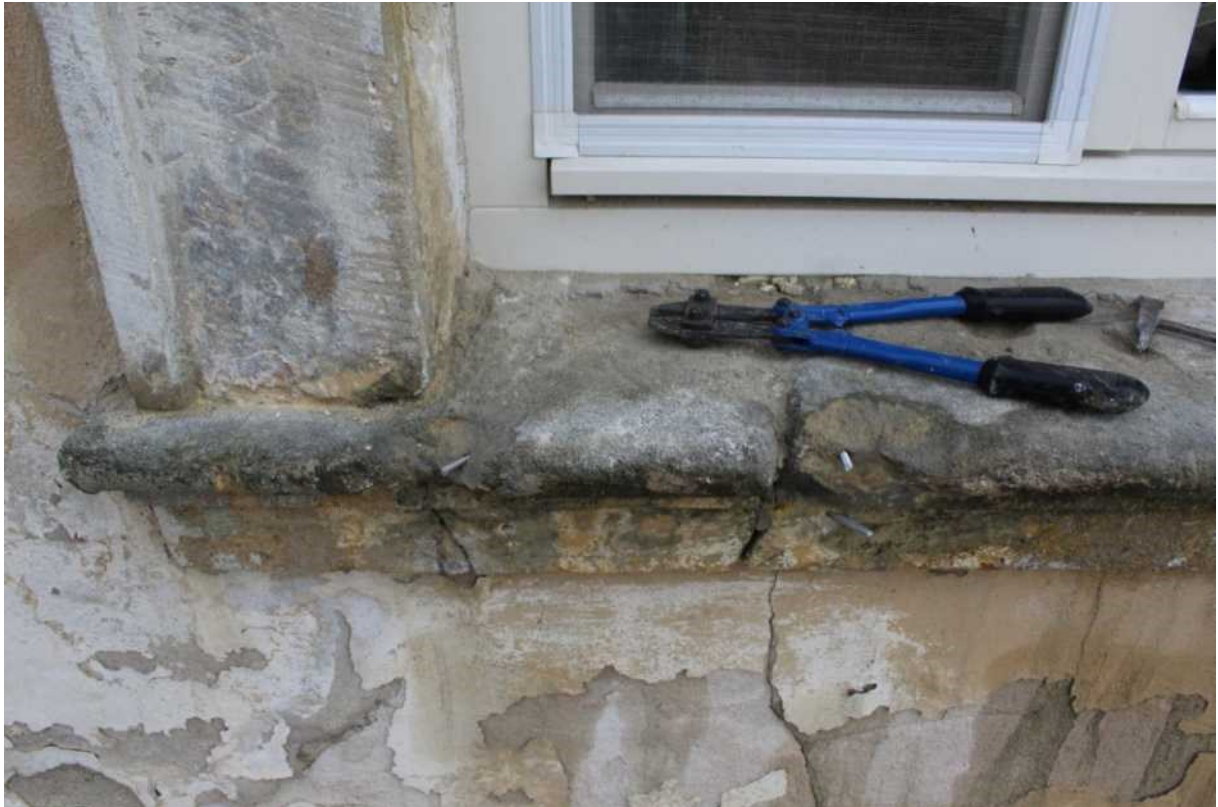
Praskliny v parapetu, četná mechanická poškození s úbytkem autentické hmoty. Fixace nerezovými čepy.
