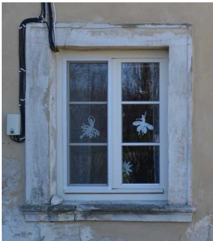
Stav okna před odstraněním nevhodných a dožitých doplňků.
