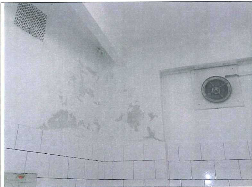
Mč. 55 umývárna vlhkostní poruchy
