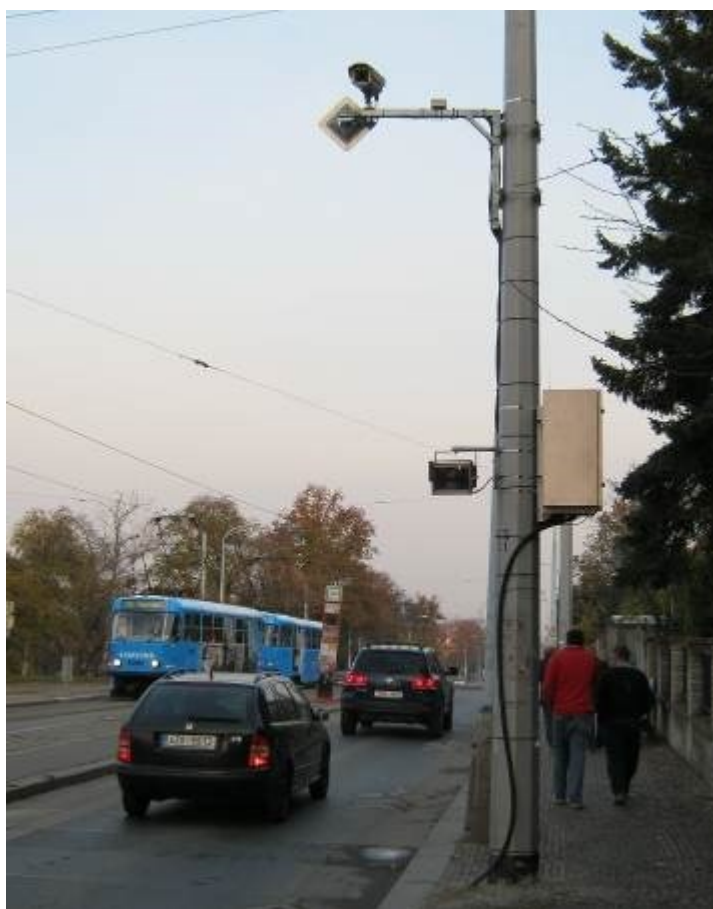
Obr. 2: Ukázka instalace systému UnicamSPEED na sloupu VO (kamerová jednotka, osvětlovací a záblesková jednotka, rozváděč s elektronikou)
