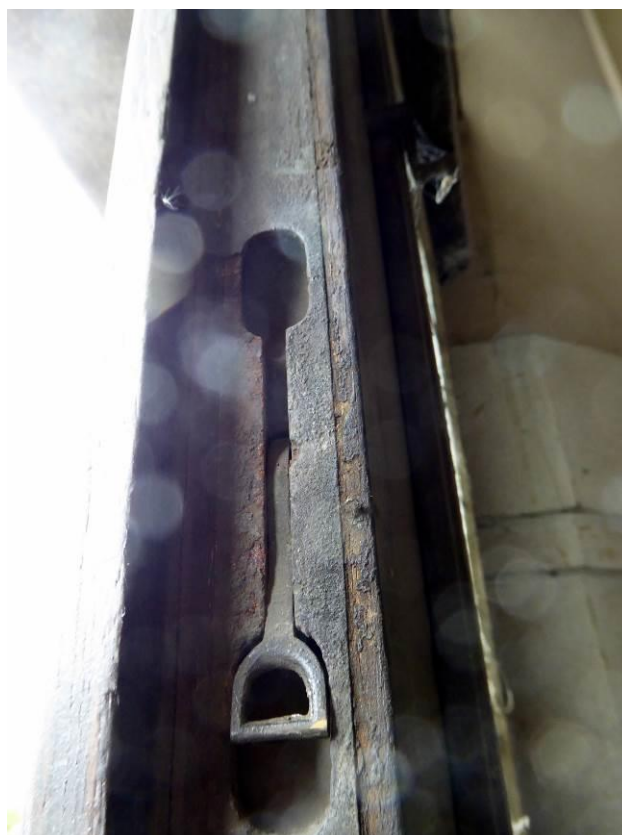
Detail značně poškozené původní horní zástrče dveří
