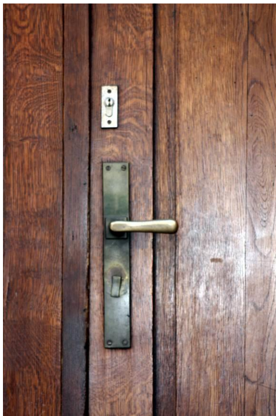
Detail původního zámku s nepůvodním přídavným zámkem
