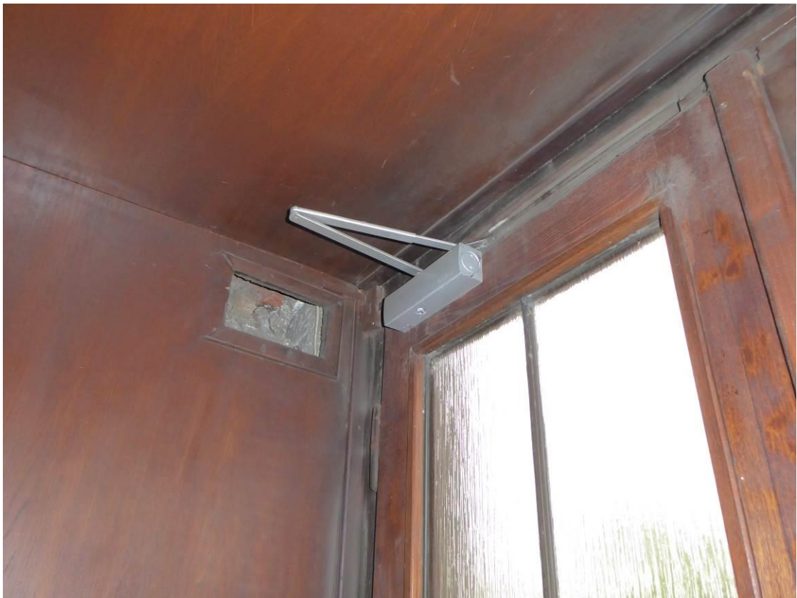
Nepůvodní samozavírač, pro který je proveden výřez v dešťění stěny
