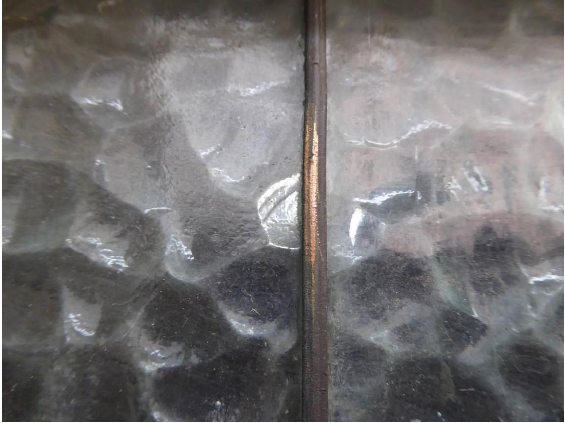
Detail měděných lišt fixujících lité sklo (lišta silně zkorodovaná)
