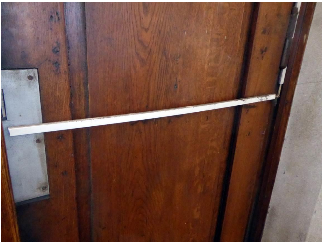
Pohled na amatérskou instalaci přívodního kabelu k elektrickému zámku
