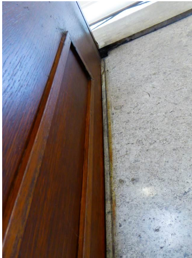
Pohled na konstrukci zádveří nasazenou na stěnu, na které je stopa po původním rámu vnitřních dveří
