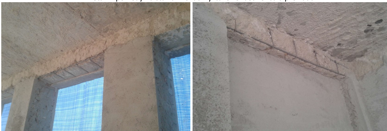
Detailní pohledy na stav armovací výztuže žel.bet věnců a překladů
