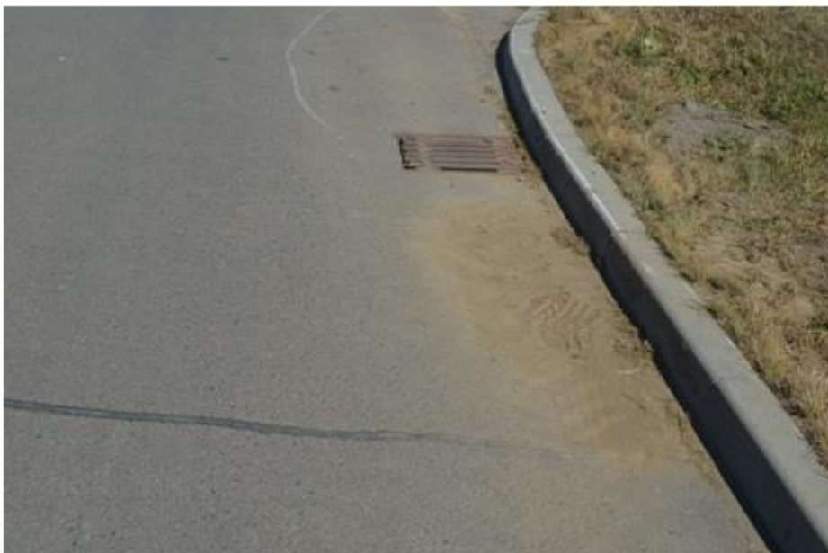
Dešťová kanalizace – silniční vpusti
