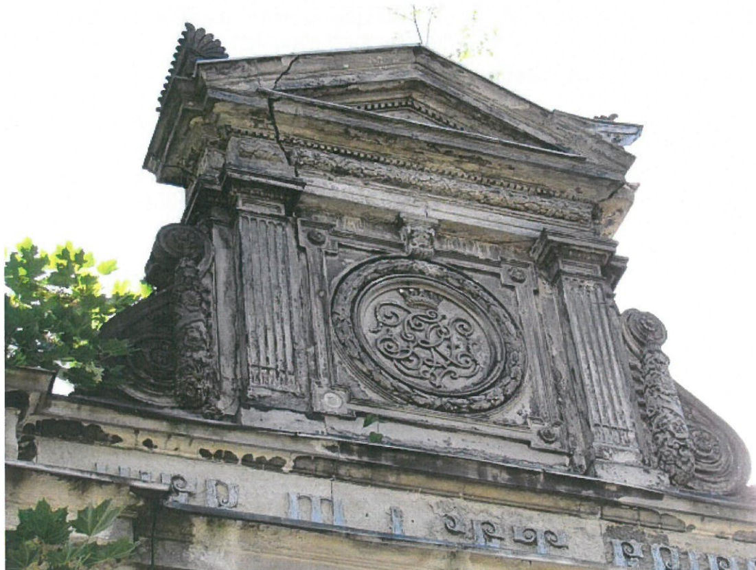
Tympanon Liebiegovy hrobky před opravou. Na levé straně v původním záměru, již popsaná a viditelná trhlinka. Dnes již demontovaná odtržená část, byla rozebrána na cca 9kusů.
