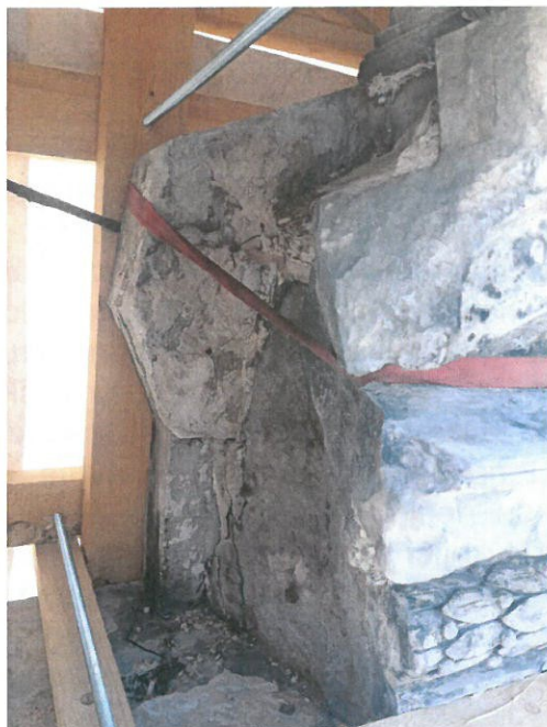
Lomová plocha na tělese tympanonu po sejmutí odtržené části ve fragmentech. Foto Vích duben 2018 po částečném odkrytí z plošiny.
