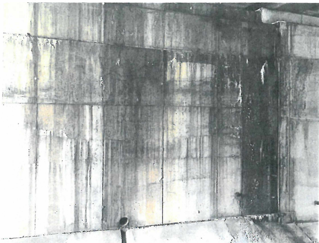
Pohled na Ostravskou opěru před sanací
