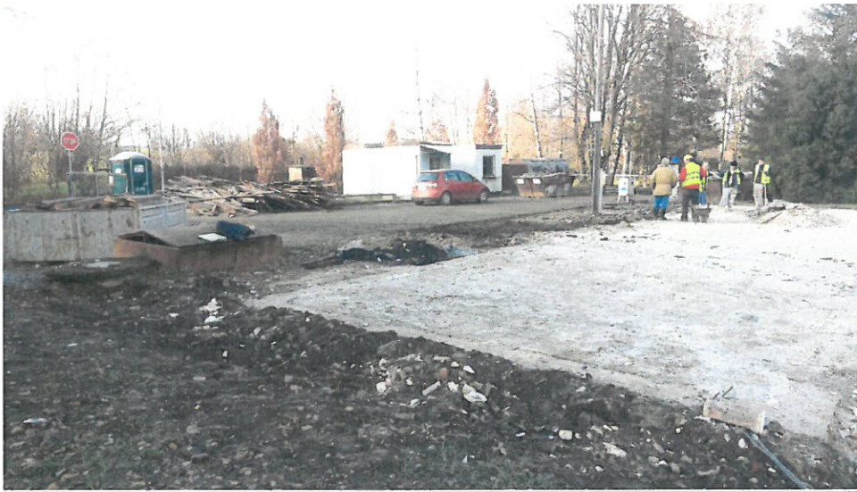
Foto 1, 2 – nízká hloubka stávajícího založení
