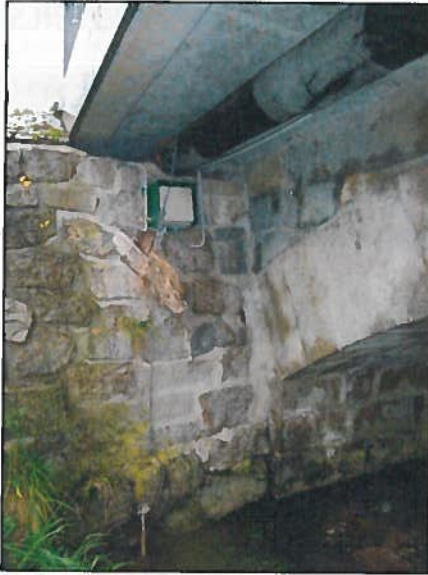
Boční stěny nad klenbou lokálně zavlhle v místě spárování. V místě zatékání přes římsu drobné trhlinky v krycí vrstvě NK. Na podhledu klenby lokální trhliny v spárování.
