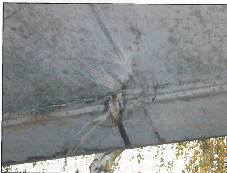
Pravá řimsa v místě dilatace u OP1 je zavhlá s patrnými průsaky.
