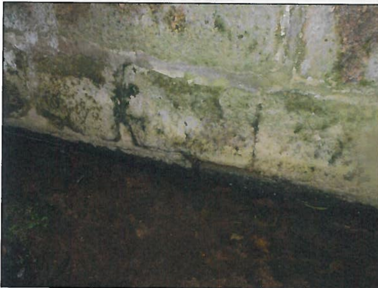
V patě pravé opěry vydrolená spárová malta. Křídla u OP2 jsou zatečená v místě vyústění kanalizace. N OP a křídlech lokálně uchycen mech.
