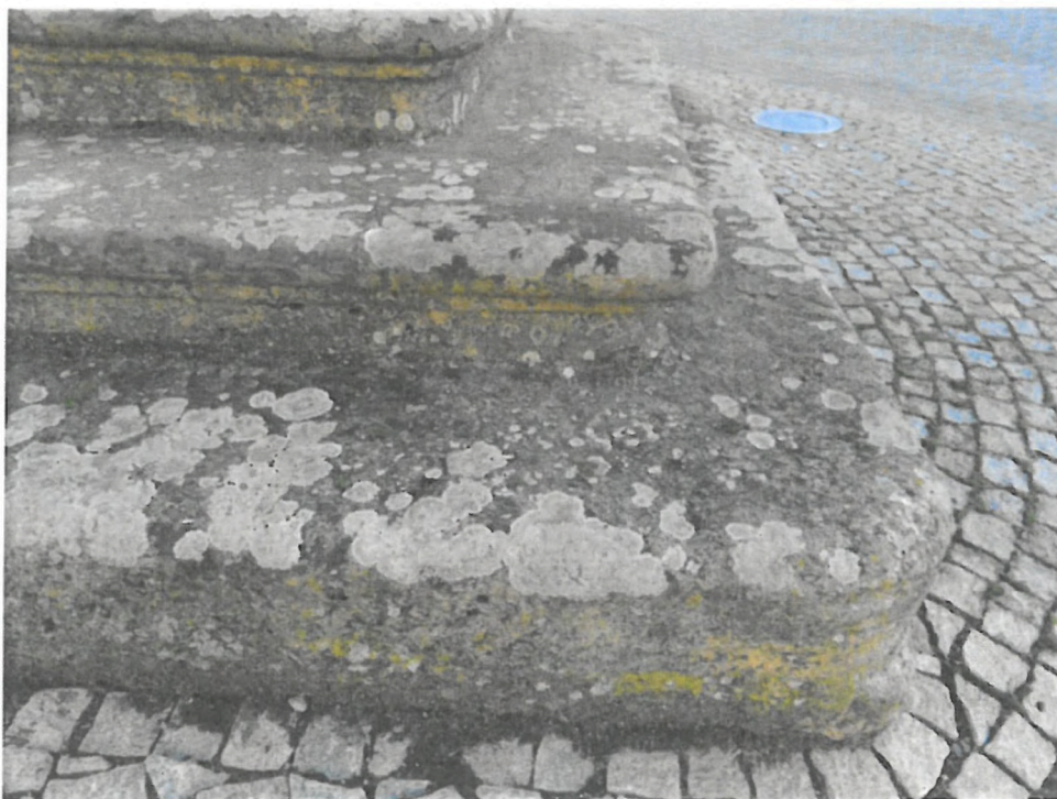
Detail schodů s biologickým napadením.
