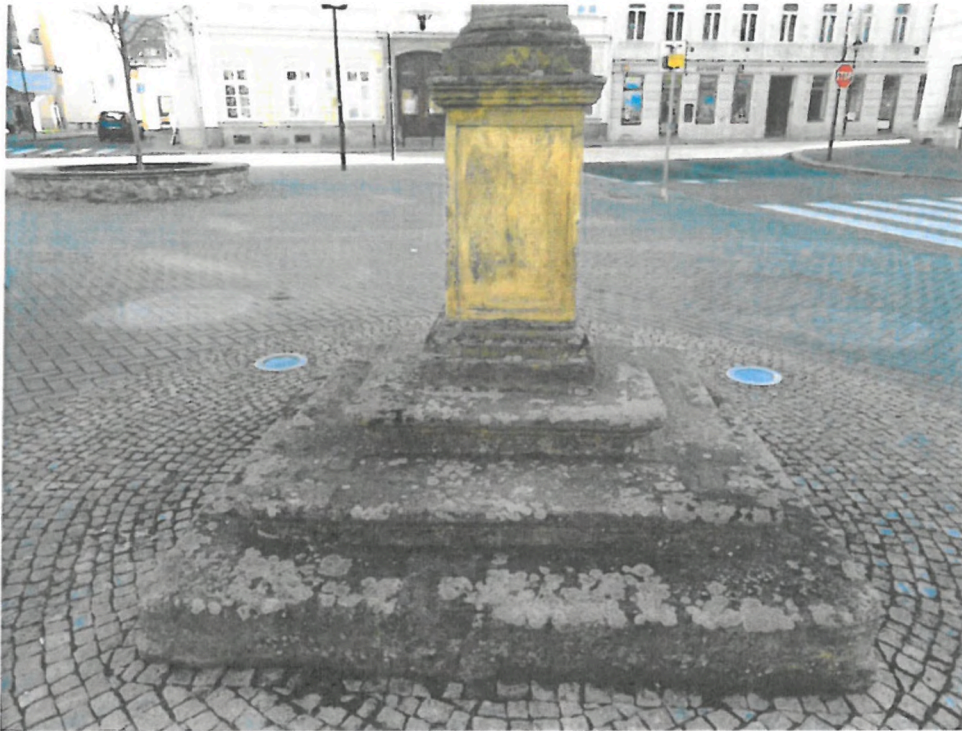
Poškozená spodní část schodového stupně – biologické napadení, depozity, mechanické poškození.
