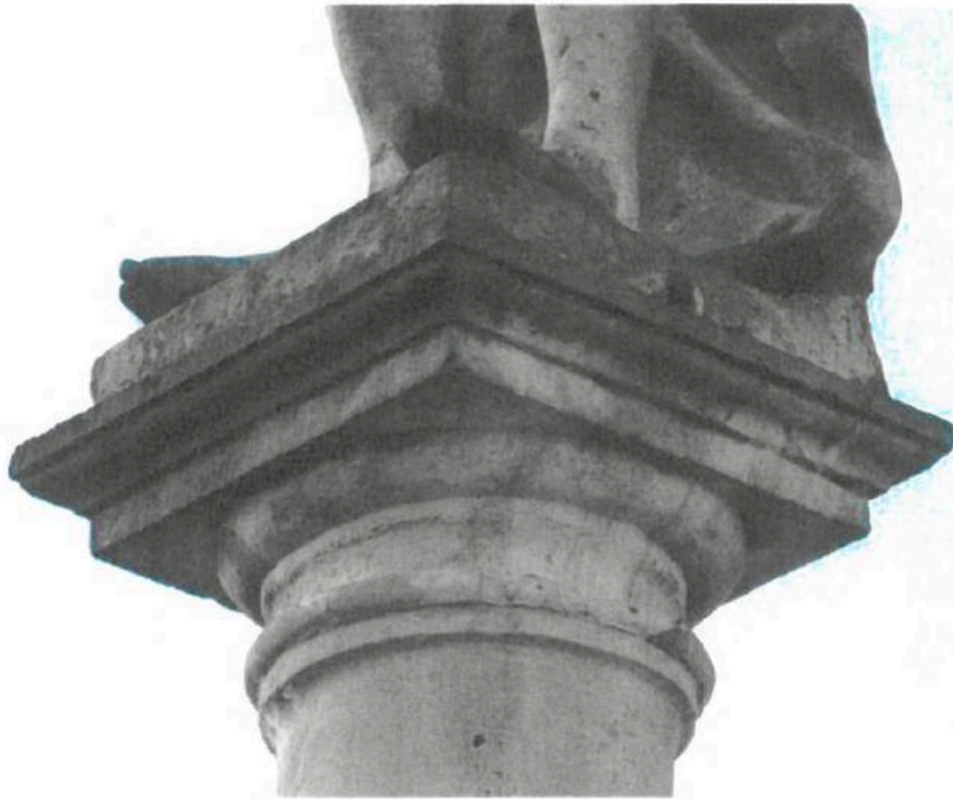
Hlavice sloupu – v horní části dřívku je kámen zvětralí.
