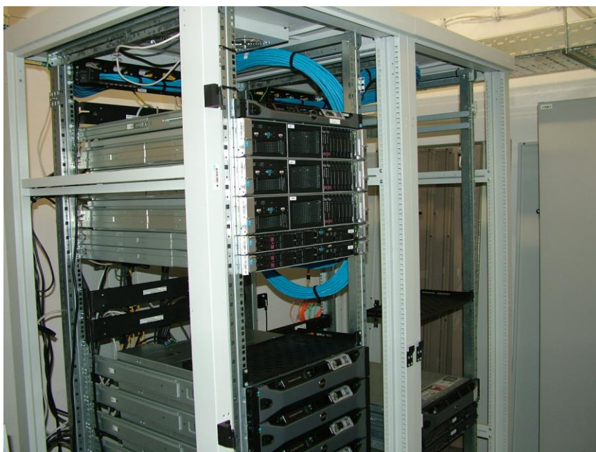
B1 P01.011 – datové centrum FF. Umístění NVR do rozvaděče na pravé pozici. V levé pozici diskové pole.
