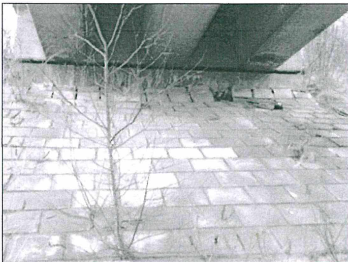
Pohled na poškozený, neudržovaný obklad před OP1.
