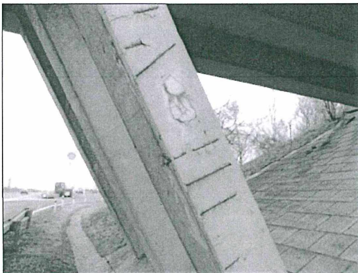
Poškozená vzpěra- viditelná, korodující výztuž.
