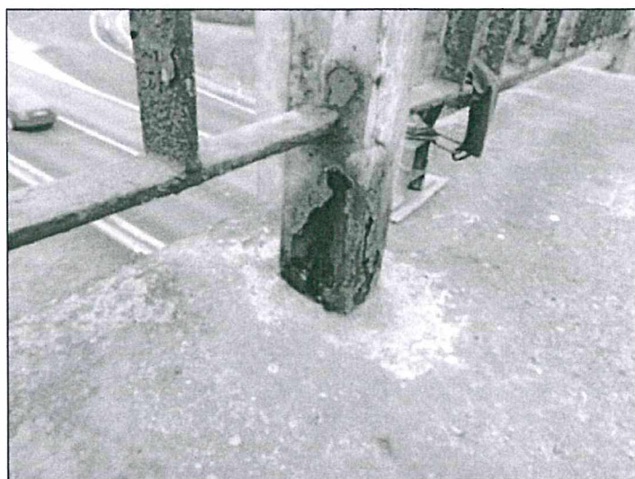
Detail poškozené konstrukce zábradlí.
