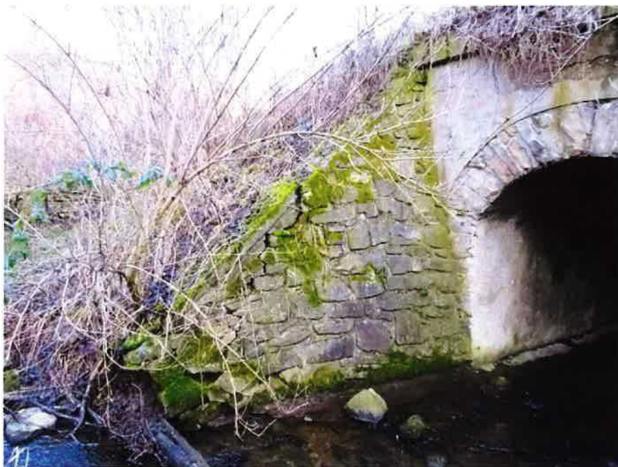
podemleté křídlo mostu 125-008
