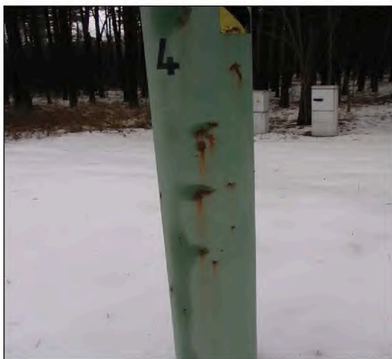
Foto č.2 – detail poškození nátěru korozi
