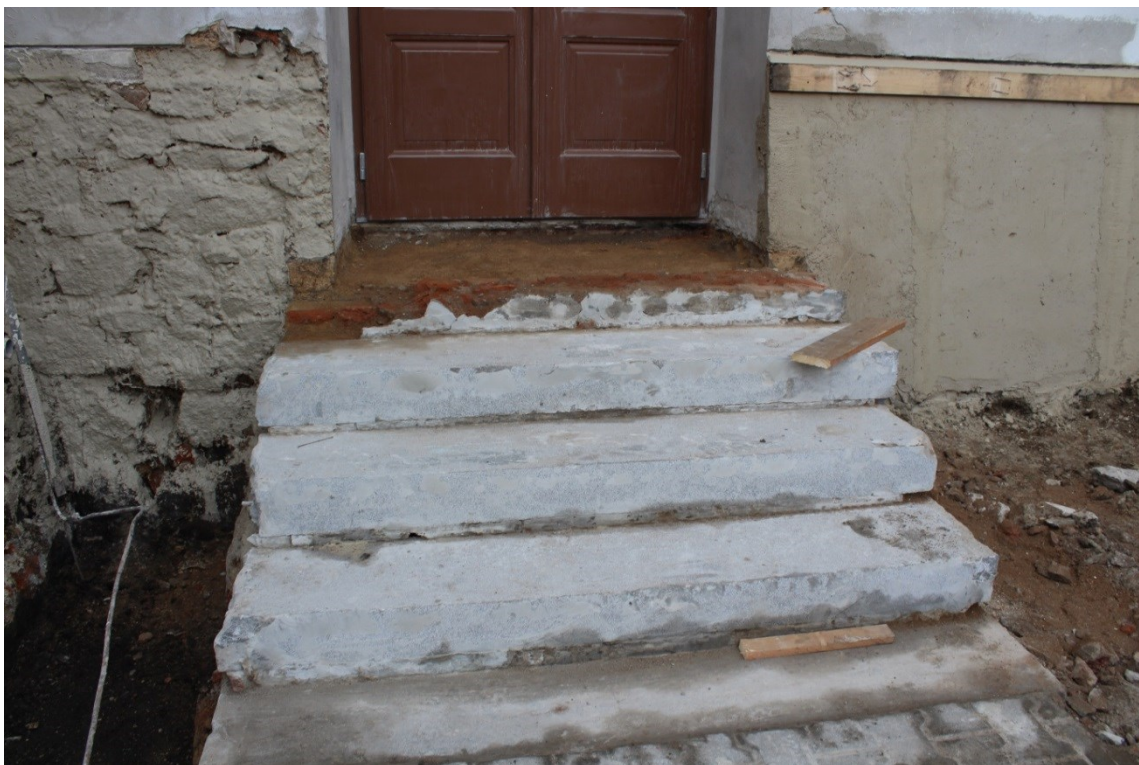
V 05: havarijní stav bočního vstupu do objektu, schodiště a boční stěny byly staticky narušené
