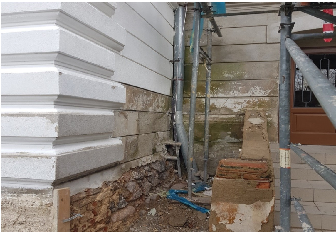
V 05: havarijní stav bočního vstupu do objektu, schodiště a boční stěny byly staticky narušené
