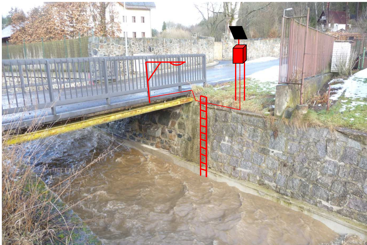
Obrázek 11 – Pohled na most proti proudu při vyšším vodním stavu a schematické umístění ultrazvukového snímače hladiny, vodočetné latě a telemetrické stanice
