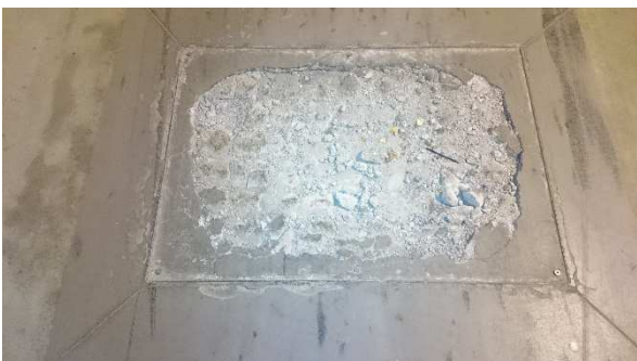
Foto 11: Poškození poklopů v blízkosti objektu A8.
