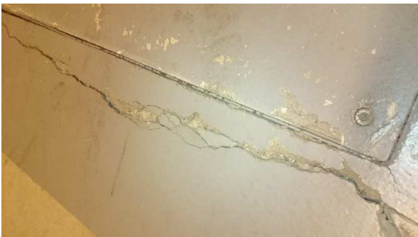
Foto 06: Detail poškození typického poklopu.
