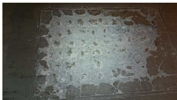
Foto 12: Poškození poklopů v blízkosti objektu A70.
