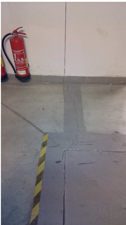
Foto 08: Poškození v místě dilatačního pole.
