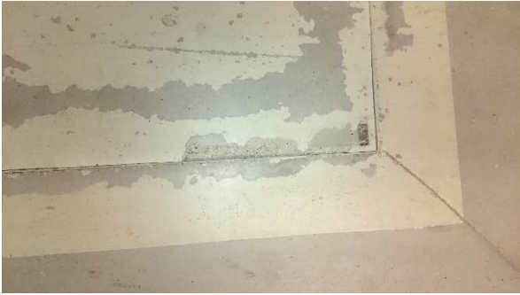
Foto 01: typické poškození výplně poklopů – rozpraskání a vydrolení výplně u rámu.
