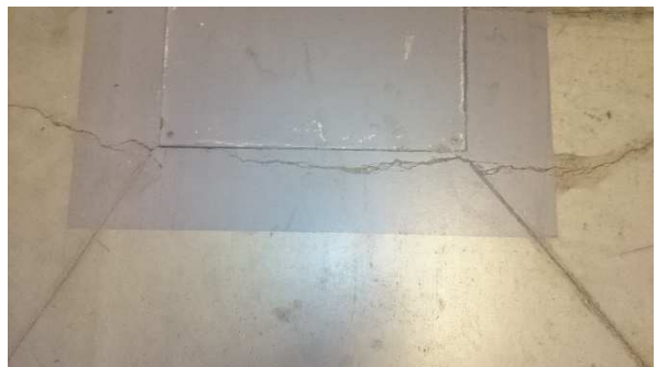
Foto 05: Poškození v místě upevnění pok.
