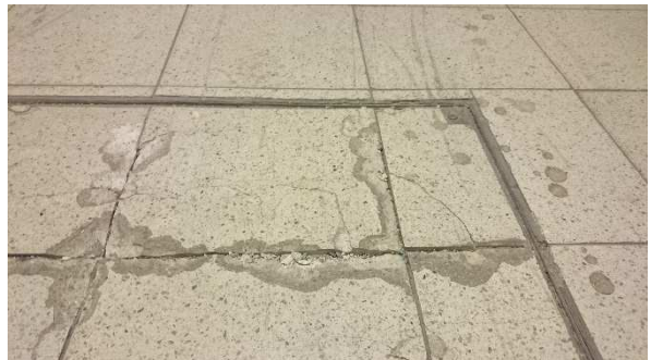
Foto 04: Detail poškození poklopu u objektu A13.
