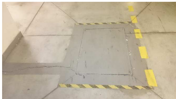
Foto 09: Poškození v místě dilatačního pole.
