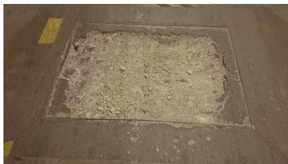
Foto 10: Poškození poklopů v blízkosti objektu A8.
