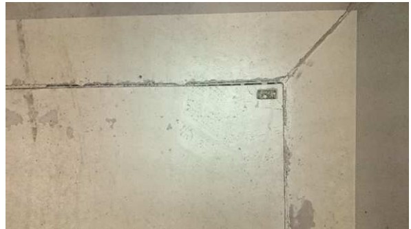
Foto 02: typické poškození výplně poklopů – rozpraskání a vydrolení výplně u rámu.
