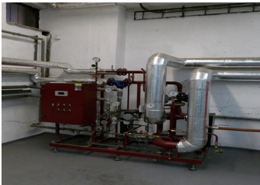
Výměňková stanice horká voda – teplá voda
