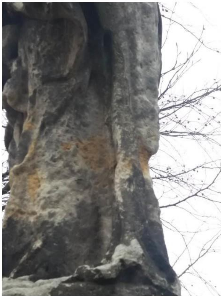
Socha sv. Pavla, současný stav poškození korozí a nálety mikrovegetace, drobné destrukce, hloubková koroze levé části, tzv. důlková koroze.
