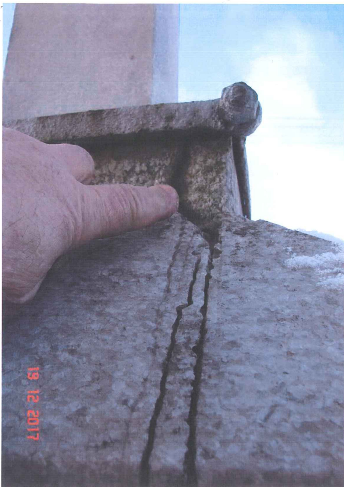
foto č. 3 kříž u kaple v Ráječku detail poškození pohled před restaurováním
