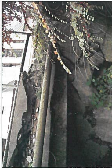
Rozpad v čele objektu na vrábku
