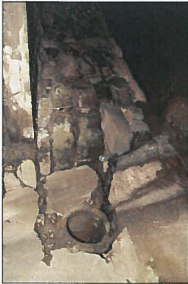
Uvolnění zřívá opěry na levoběžném vrábku
