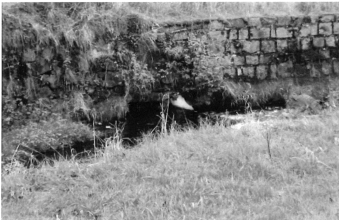
Obrázek 2: Poškozené základy zdí
