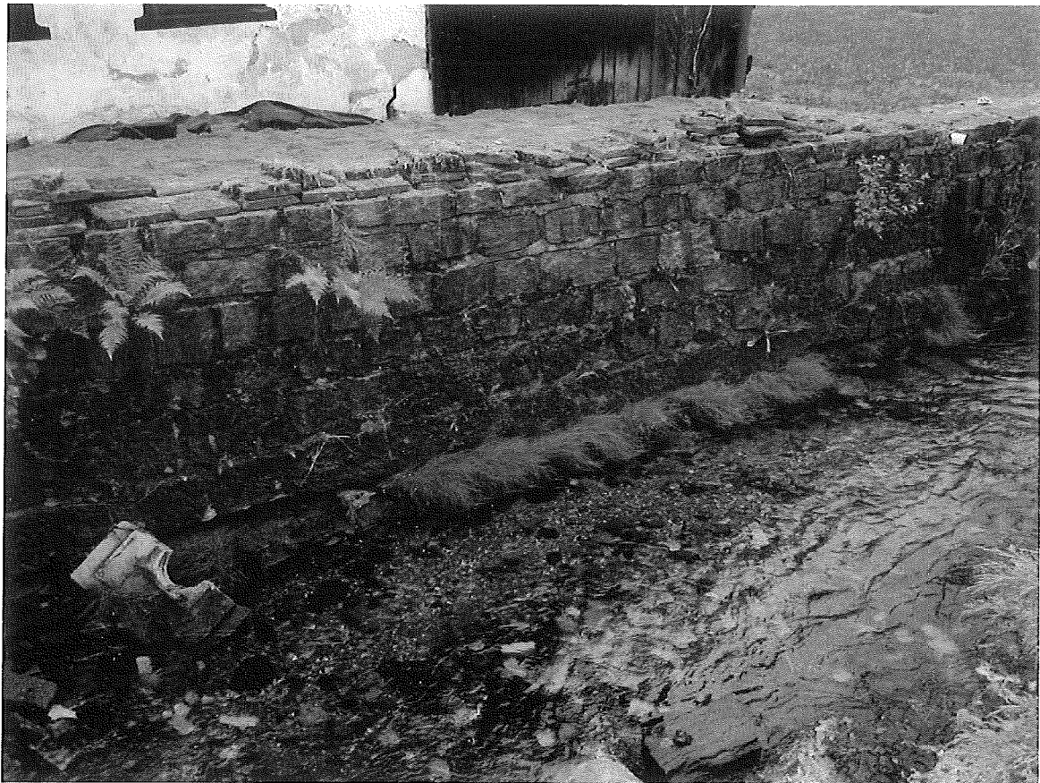
Obrázek 3: Poškozené základy na LB v ř.m 0,045 - 0,065
