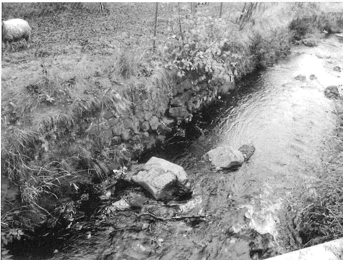
Obrázek 1: Rozbitá zed' na LB ř.km 0,095 - 0,098
